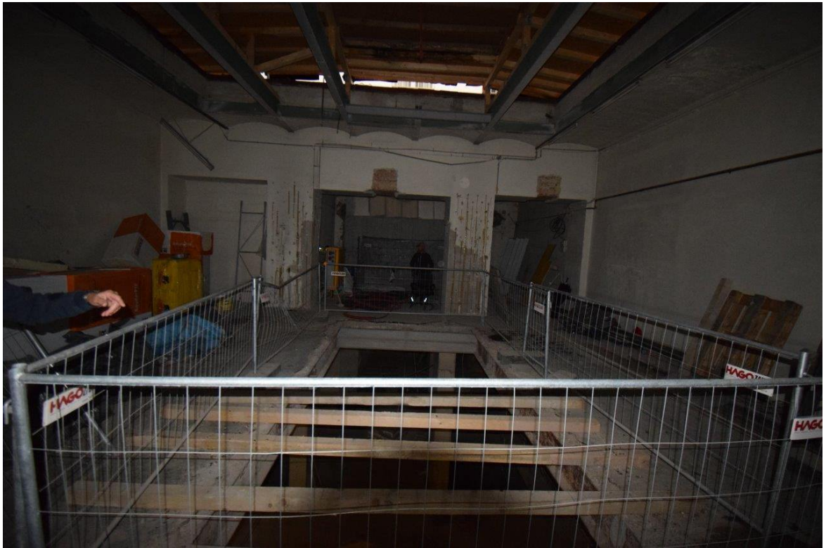
Geschäftslokal EG I – fehlendes Glasdach
