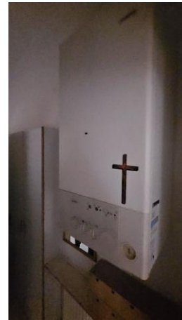
Heiztherme (nicht überprüft)
