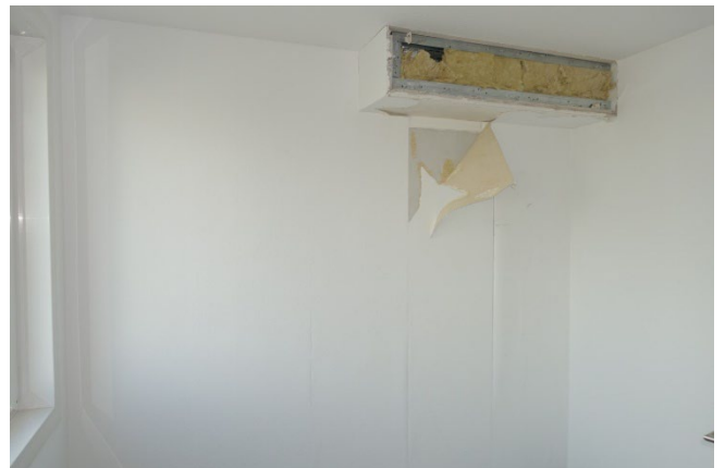
Abbildung: Zimmer (Wasserschaden an der Wand)
