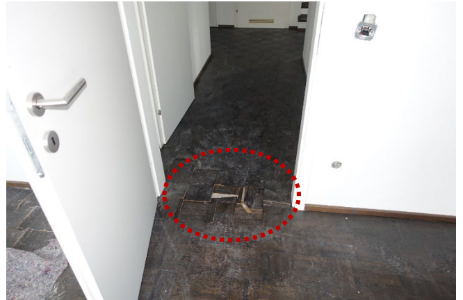
Abbildung: Zimmer (Wasserschaden am Boden)
