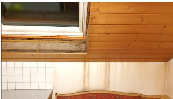
Abb 74: Nässespuren – aber nicht immer so deutlich ausgeprägt wie hier über der Eckbank in der Wohnküche - sind an zahlreichen Stellen der Dachwohnung sichtbar.
