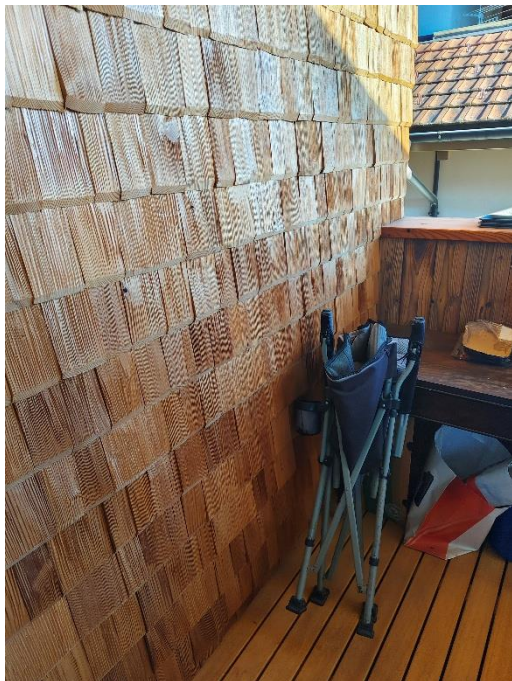
Abbildung 38: Holzschindel im Balkon Bereich
