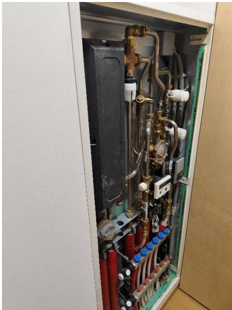
Abbildung 50: Warmwasserverteiler inkl. Wärmetauscher
