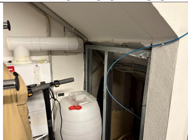
Abbildung 26: Abstellraum (kl. Setzungsriss)
