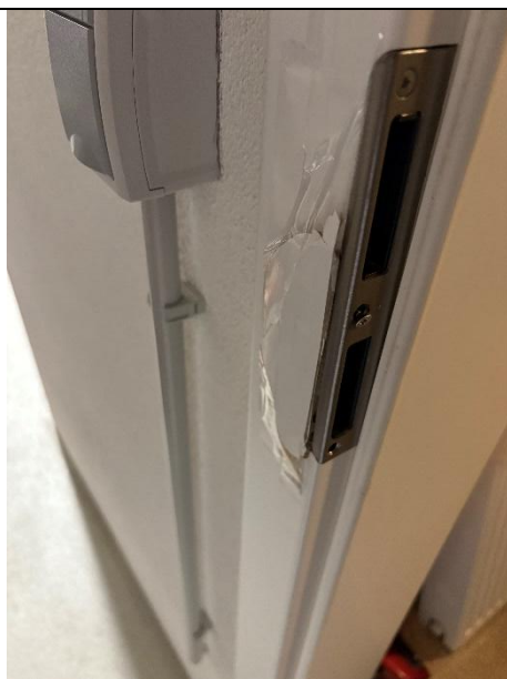
Abbildung 31: Türrahmen im Untergeschoss
