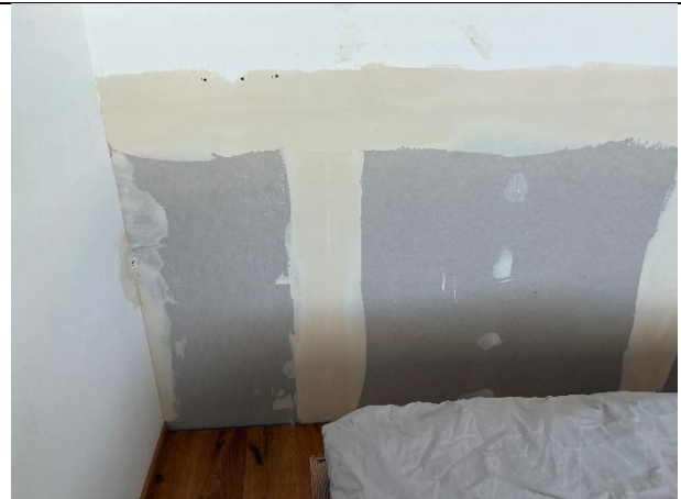
Abbildung 60: Schlafzimmer 1 / Detailbetrachtung reparierter Wasserschaden
