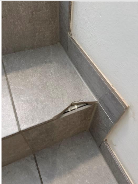
Abbildung 33: Treppe in das Erdgeschoss / schadhafter Fliesenbelag
