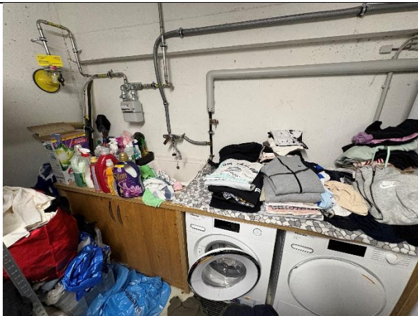
Abbildung 29: Abstellraum / Bereich Waschmaschine & Trockner
