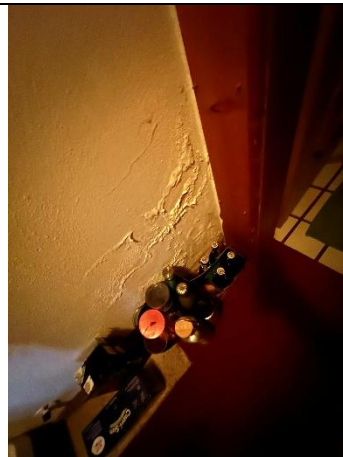
Abbildung 42: Ausblühung Wand EG (1/3)
