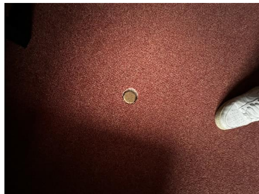
Abbildung 38: Loch im Teppichboden EG
