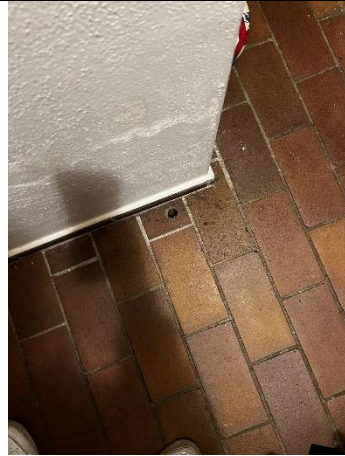
Abbildung 46: Beschädigung im Fliesenboden
