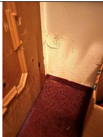
Abbildung 44: Ausblühung Wand EG (3/3)
