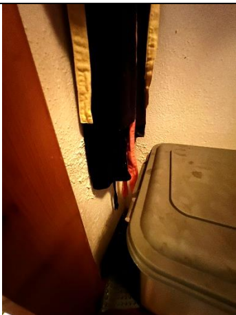
Abbildung 43: Ausblühung Wand EG (2/3)
