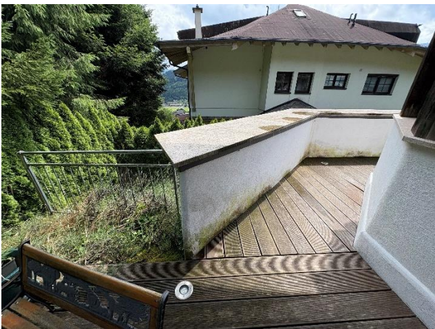
Abbildung 170: Algen / Moosbefall Balkon
