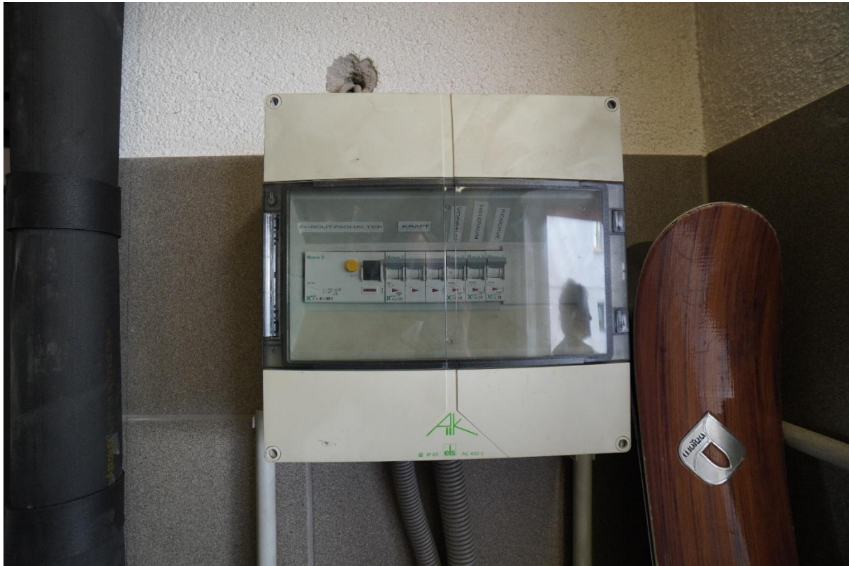
Sicherungskasten Vorraum EG
