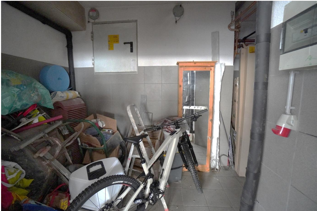
Vorraum mit Pelletslager EG
