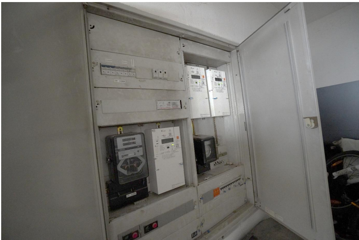
Strom-Hauptverteiler im Müllraum EG
