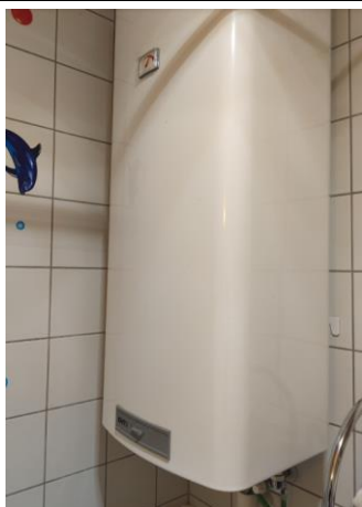
Abbildung 48: Boiler im Badezimmer
