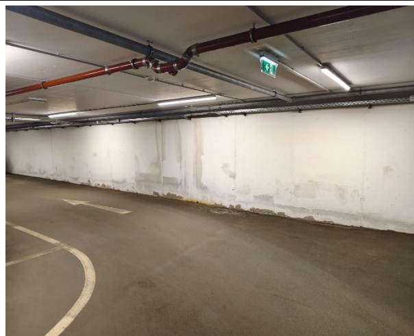
Abbildung 70: Garage (Hinweis: Feuchtigkeitsprobleme wie oben beschrieben)
