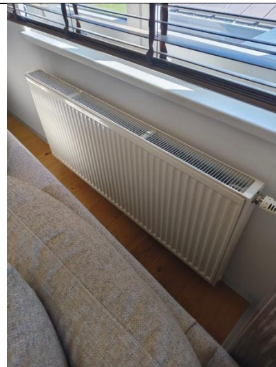
Abbildung 32: Heizkörper im Wohnzimmer
