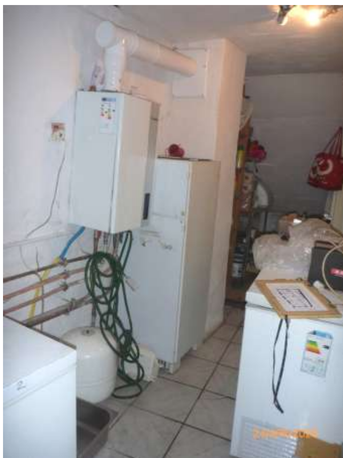
Bild 12: Erdgeschoss- Raum mit Gasbrennwerttherme für Erd- und 1. Obergeschoss
