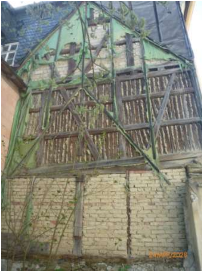
Bild 5: die Gebäuderückseite ist der Bewitterung vollkommen ausgesetzt
