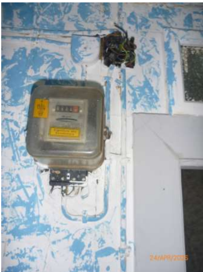
Bild 26: 2. Obergeschoss- Detail- bild zu Bild 25; überalterte Aufputzinstallation mit Unterzähler und offener Verteilerdose
