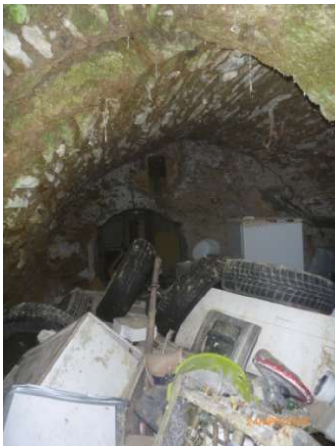
Bild 30: Nebengebäude- Blick durch die offene Stahltür auf Müllablagerungen im Innenraum
