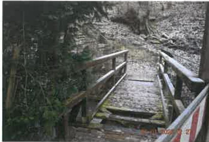
rückwärtige, schadhafte Brücke über die Rinne (gehört nicht mehr zum Bewertungsgrundstück)
