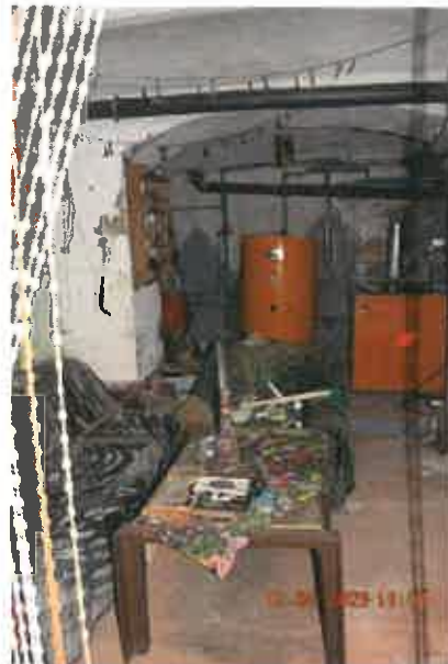
Kellerraum mit Heizungsanlage
