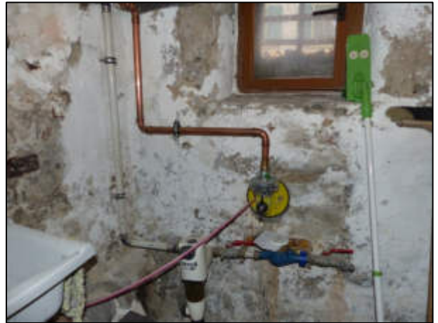
Foto 28: Baumängel / Bauschäden - Aufsteigende Feuchtigkeit im Kellergeschoss
