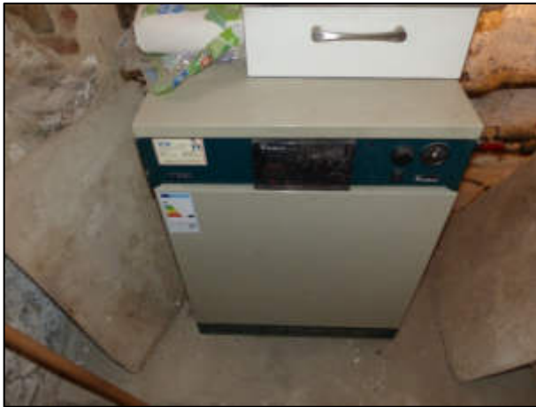
Foto 19: Techn. Ausstattung – Heizungsanlage mit Baujahr 1992
