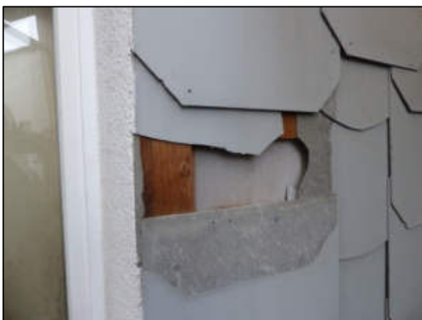
Foto 29: Baumängel / Bauschäden - teilweise Fehlstellen an der Eternitverkleidung an der Fassade
