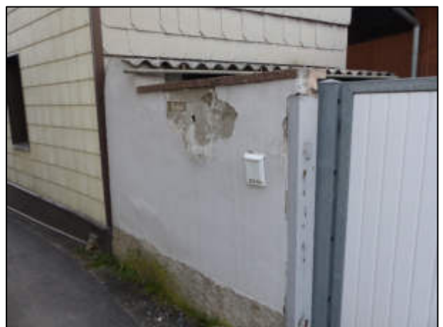
Foto 30: Baumängel / Bauschäden Putzschaden an der Einfriedungsmauer im südwestlichen Grundstücksbereich
