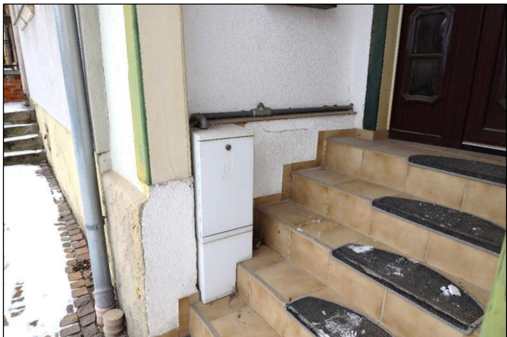
Risserscheinungen am Hauseingangsbereich – Einfamilienwohnhaus / Reihenmittelhaus
