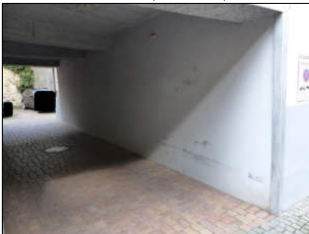
Bild 15: Zufahrt zum Grundstück Schrammspuren im Einfahrtsbereich
