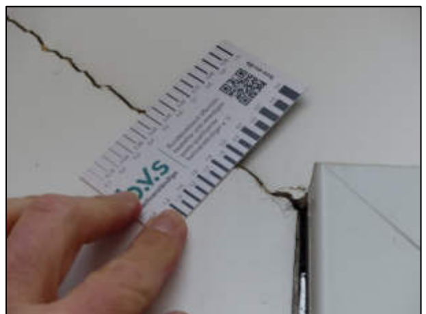
Bild 12: Baumängel/Bauschäden Riss an der Wand im Treppenhaus DG Rissbreiten 0,5 mm – 0,8 mm
