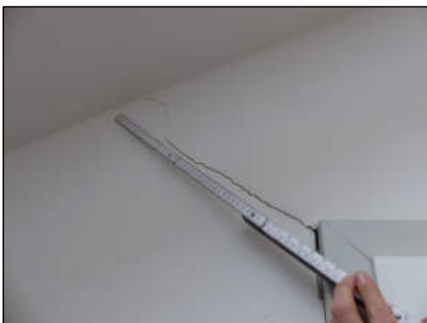
Bild 11: Baumängel/Bauschäden Riss an der Wand im Treppenhaus DG Risslänge 50 cm
