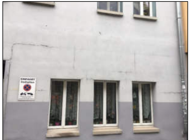
Bild 14: Baumängel/Bauschäden Risse an der Fassade Südseite Balkonanlage 2. OG – Rissbreiten 0,2 mm bis 0,6 mm
