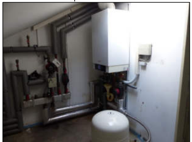
Bild 06: Dachgeschoss - Techn. Ausstattung Heizungsanlage, gemeinsam genutzt durch Kirchgasse 5/7
