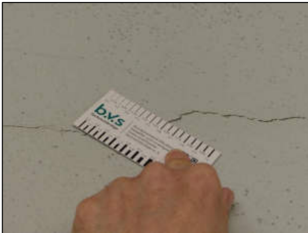
Bild 13: Baumängel/Bauschäden – 2. OG Risse an der Fassade Nordseite (Balkonanlage), Risslängen 40 cm bis 80 cm, Rissbreiten 0,2 mm bis 0,6 mm
