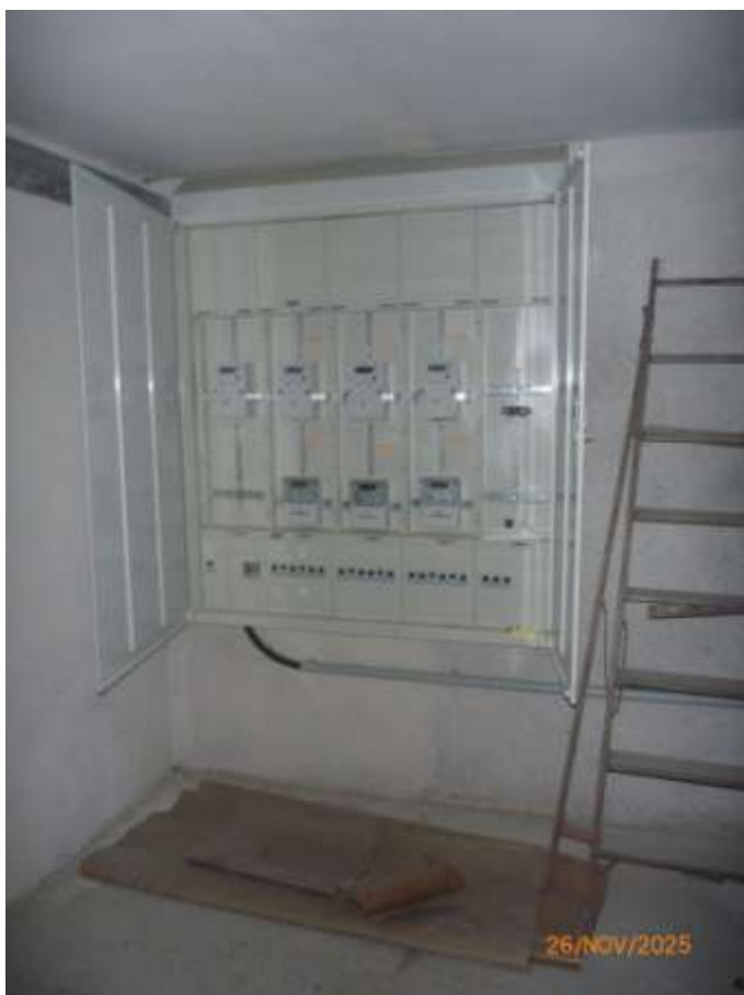
Bild 8: Kellergeschoss; Zählerkasten für Hauseingang 31
