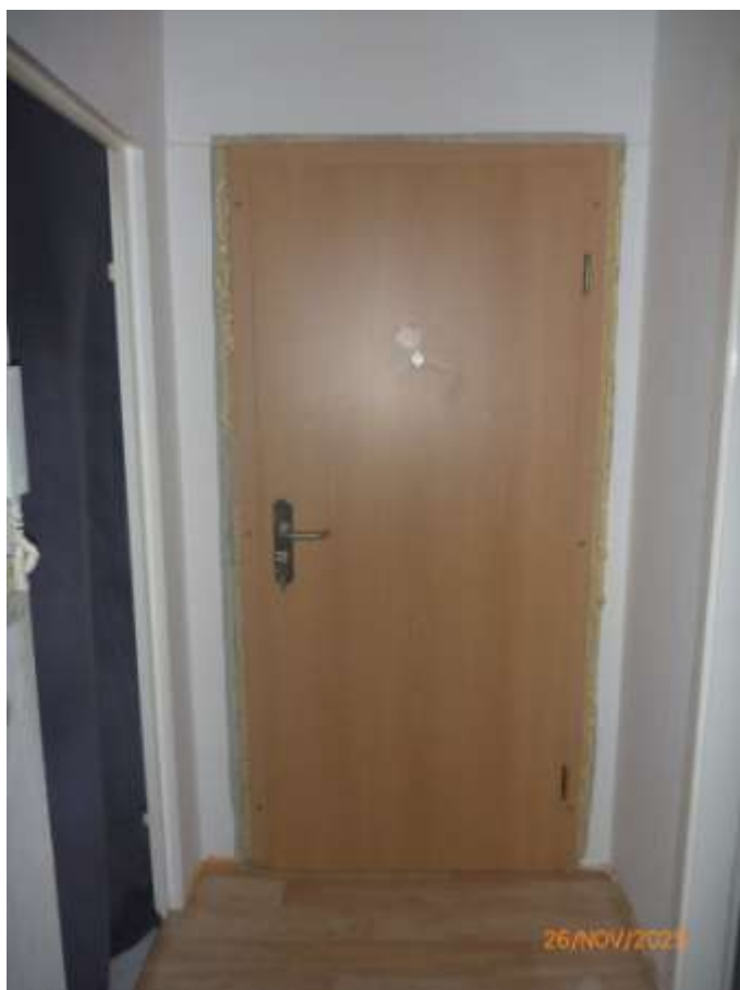
Bild 6: WE-Nr. 30; Flur mit Zugang zu den Wohnräumen, links Zugang zum Bad; die Wohnungseingangstür wurde nach einem vorangegangenen Küchenbrand bereits ersetzt
