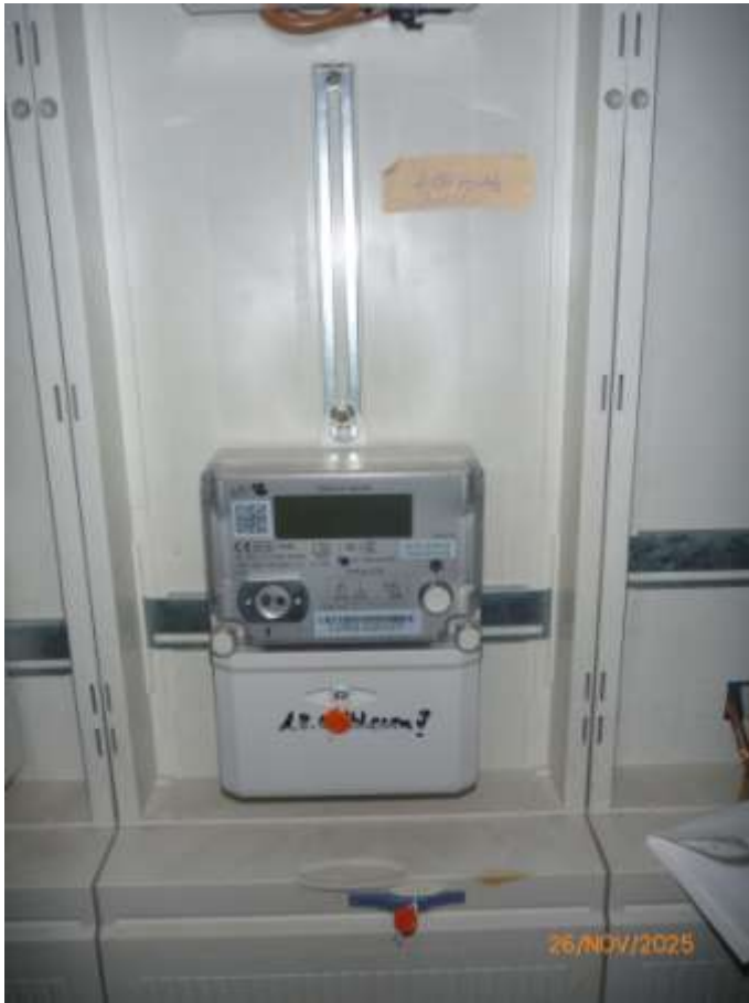
Bild 8: Kellergeschoss; der WE-Nr. 30 zugeord- neter Elektrozähler
