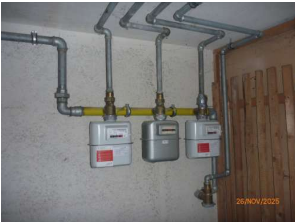
Bild 10: Kellergeschoss; jede Wohnung in dem Block hat einen eigenen Gas- zähler; hier die 3 Zähler für Hauseingang 31 / rechts
