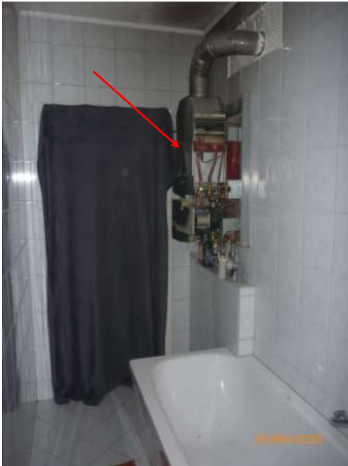
Bild 7: WE-Nr. 30; Bad mit Wanne, Waschtisch und WC; die Gastherme (s. Pfeil) für Heizung und Warmwasserbereitung ist brandgeschädigt und muss ersetzt werden
