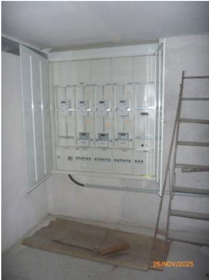
Bild 7: Kellergeschoss; Zählerkasten für Haus- eingang 31
