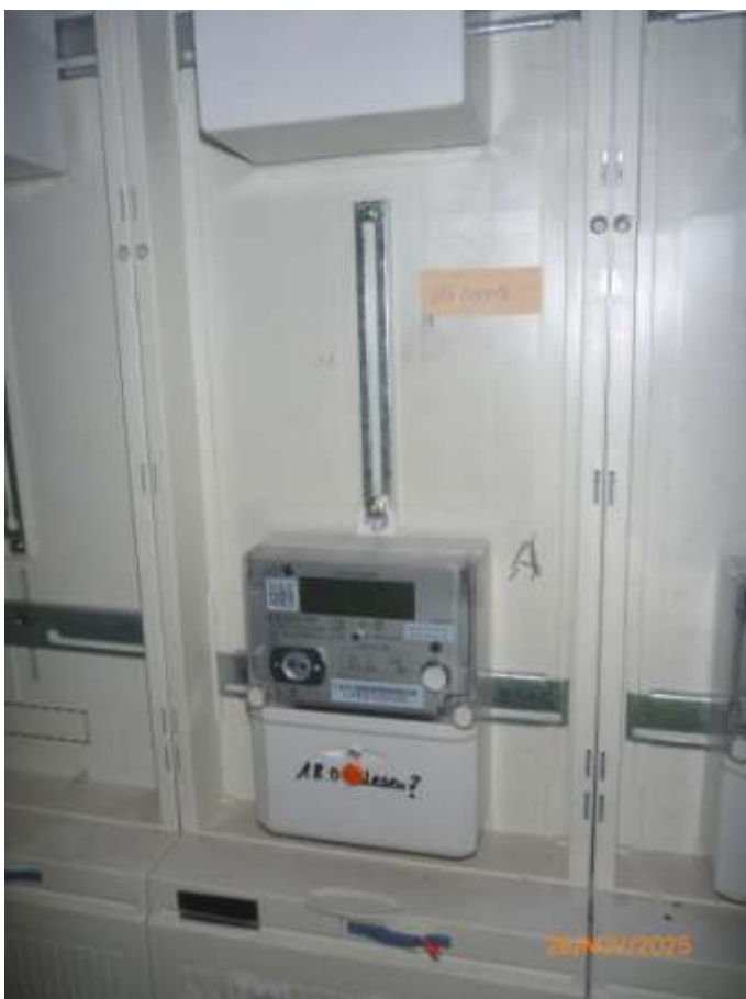
Bild 8: Kellergeschoss; der WE-Nr. 6 zugeordneter Elektrozähler
