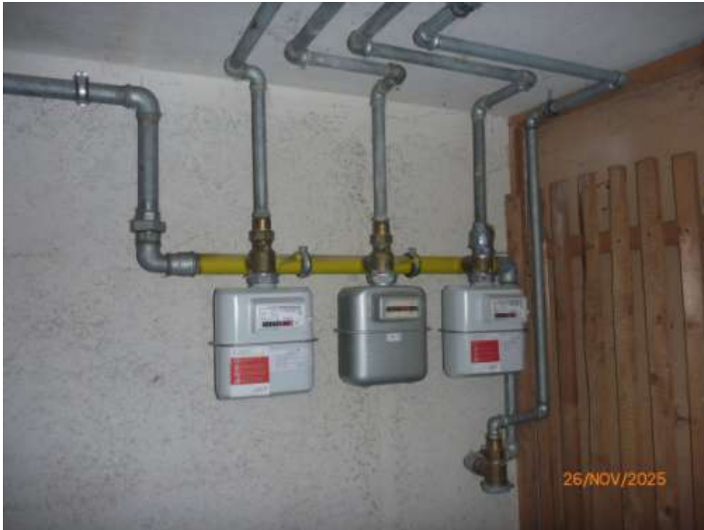
Bild 9: Kellergeschoss; jede Wohnung in dem Block hat einen eigenen Gaszähler; hier die 3 Zähler für Hauseingang 31 / rechts
