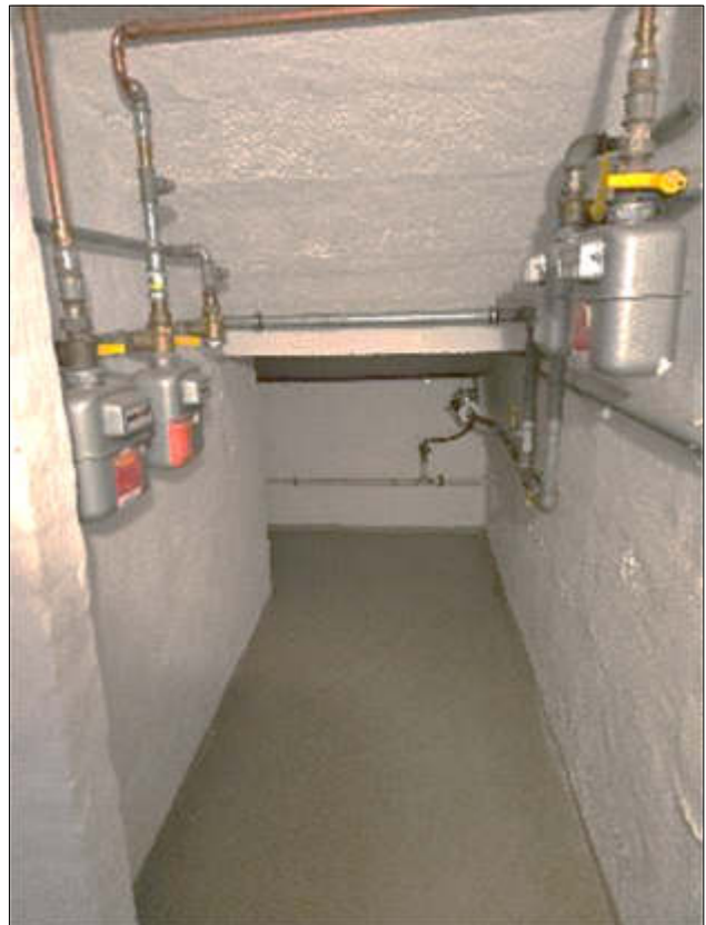
Bild 10 Pos. 01 Wohnhaus, innen, KG Flur mit Erdgaszählern, gemeinschaftliches Eigentum
