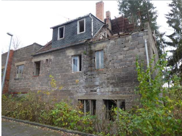
Hintergebäude Süd - West - Ansicht fehlendes Fenster- recht Foto 2
