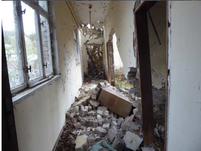
Deckendurchbruch westliches Nebengebäude Foto 7
