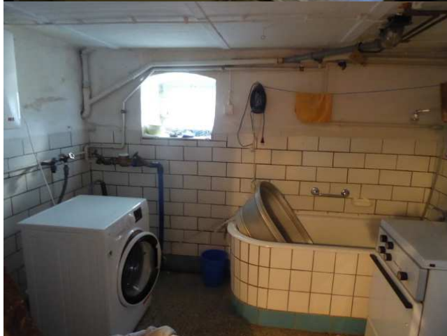
Waschhaus im Keller Foto 8
