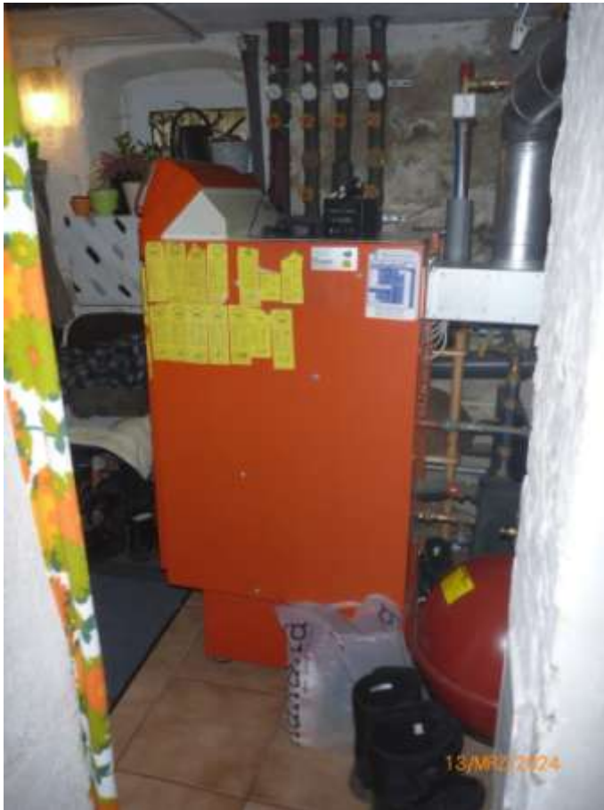
Bild 7: Warmwasserzentralheizung mit Gas-Niedertemperatur- kessel im Keller des Wohn- gebäudes
