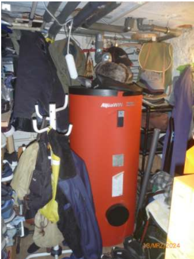
Bild 8: zentraler Warmwasserspei- cher im Keller des Wohn- gebäudes
