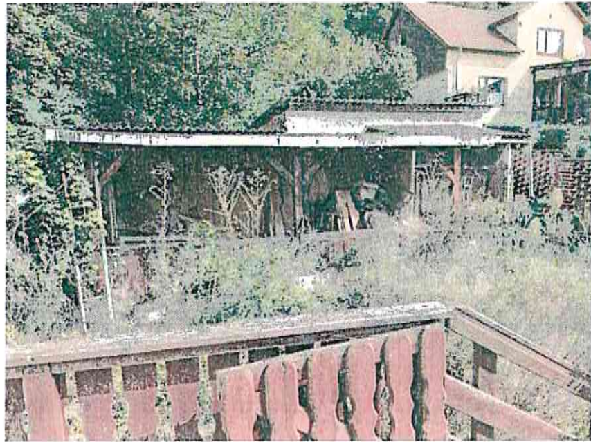
17) Garage und Schuppen aufgrund Bauzustand symbolischer Wert 1,- EUR
