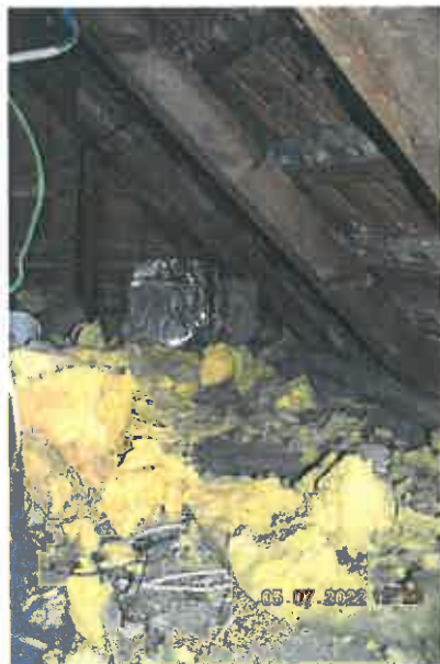
Abseite mit unzureichender Dämmung Dachgeschoss
