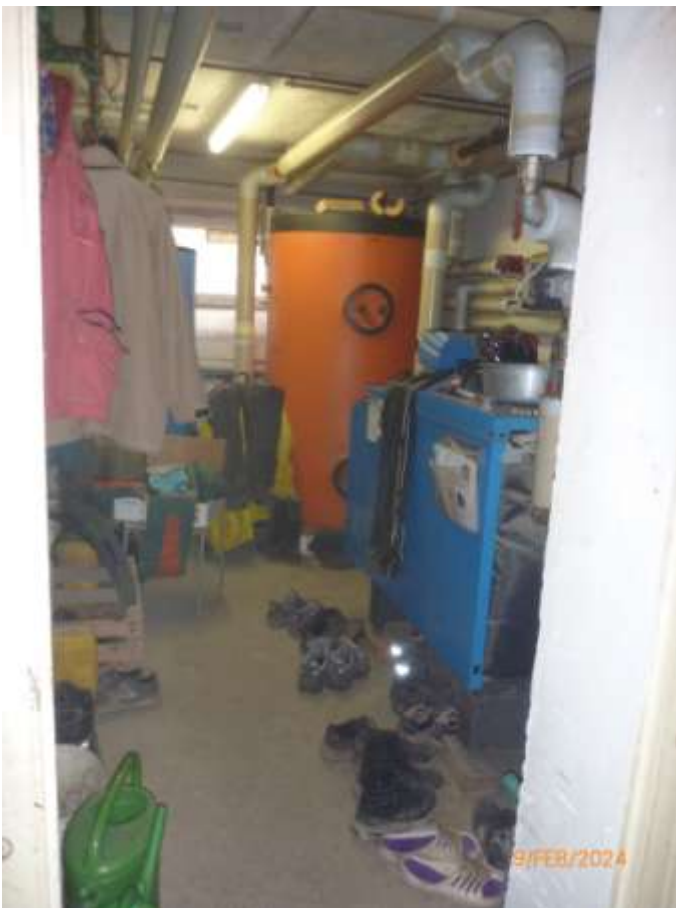
Bild 16: Wohngebäude-II; Heizungsraum mit Ölheiz- kessel und zentraler Warmwasserbereitung im Erdgeschoss
