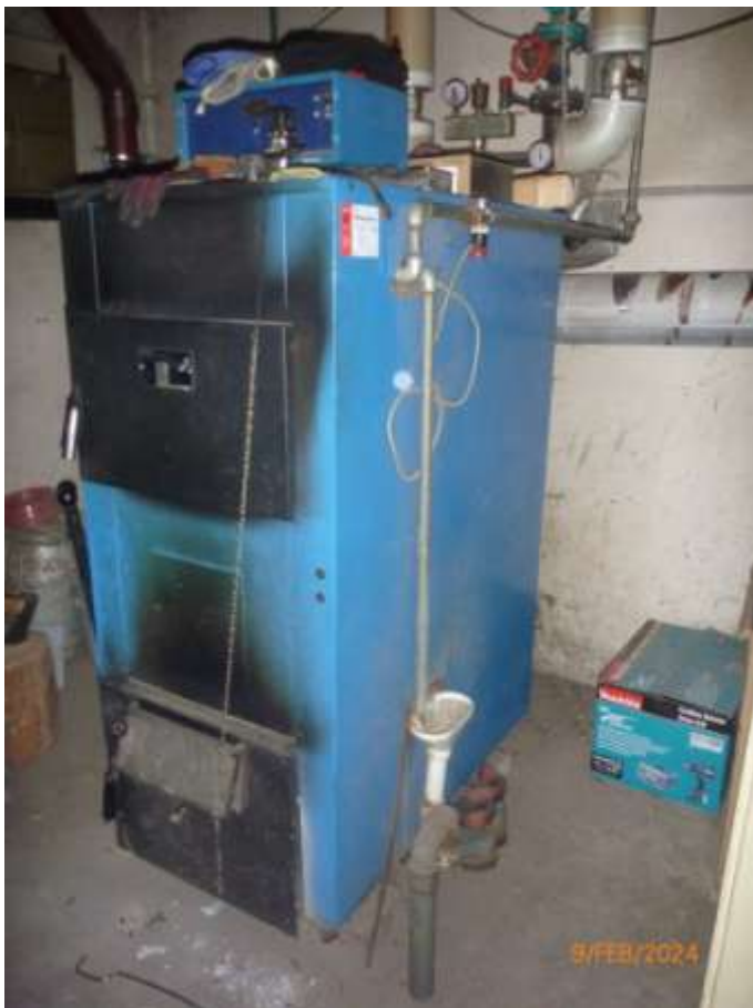
Bild 18: Wohngebäude-II; Holz- bzw. Festbrennstoff- kessel im Nebenraum im Erdgeschoss, bivalenter Betrieb mit Öl- heizkessel ist möglich
