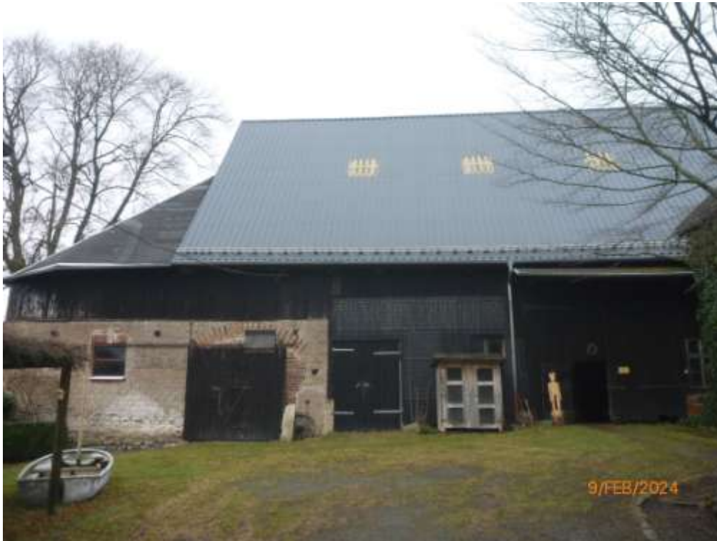
Bild 31 : Ansicht der Scheune-IV vom Innenhof; rechts großes Tor als Scheunendurchfahrt, links massiver seitlicher Anbau
