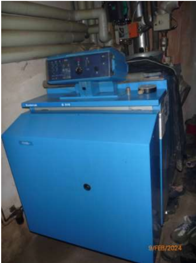
Bild 17: Wohngebäude-II; Warmwasserzentralheizung mit Ölheizkessel im Erdgeschoss
