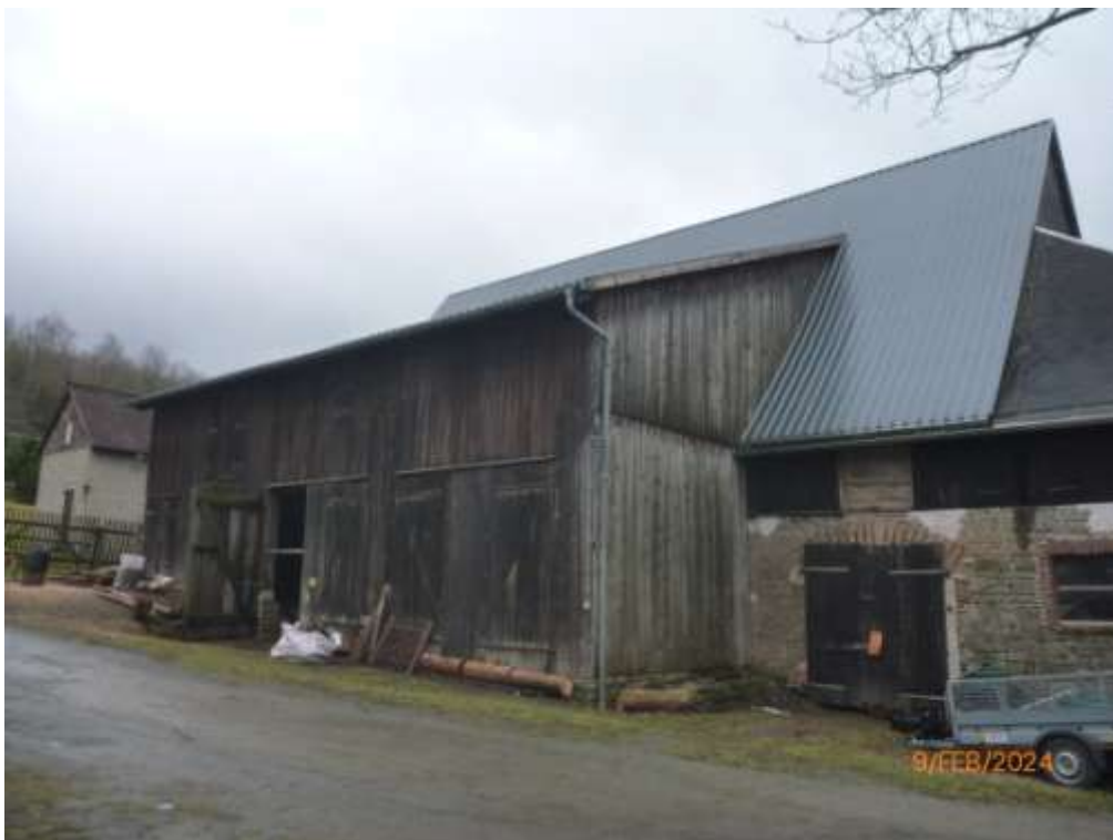
Bild 34: Ansicht der Scheune-IV vom nördlich angrenzenden Nachbargrundstück; der als eingehaustes Schleppehdach errichtete Scheunenbau steht als Überbau auf diesem Nachbargrundstück
