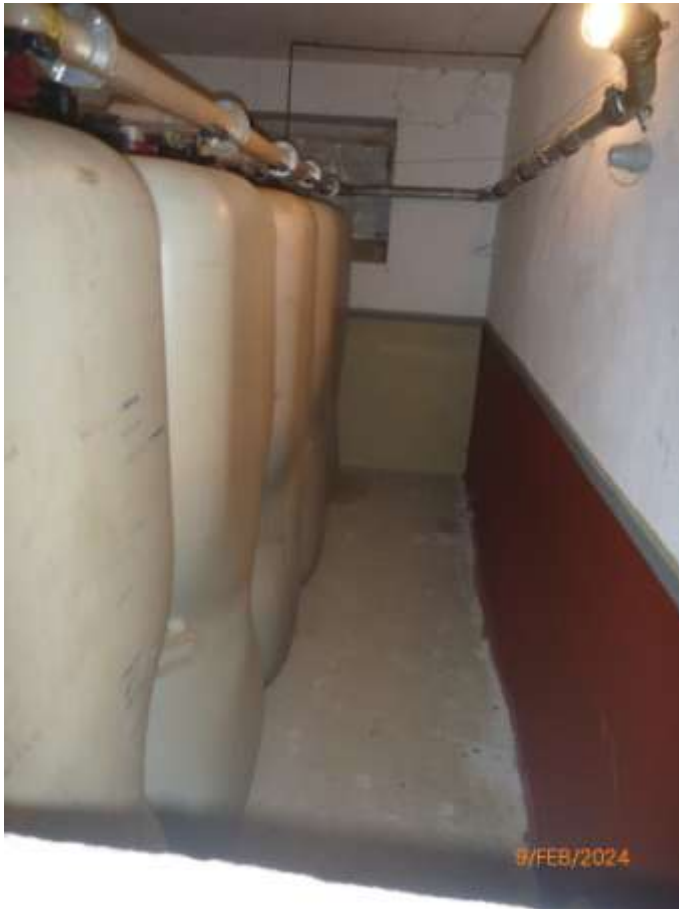
Bild 15: Wohngebäude-II; Heizöllagerraum mit Auffangwanne im Erdgeschoss
