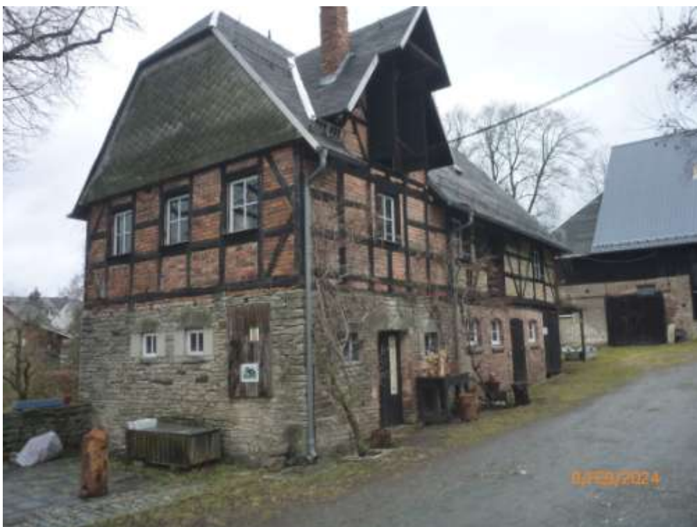
Bild 26: Ansicht des Nebengebäudes-III vom Innenhof; im Hintergrund der massive seitliche Anbau der Scheune-IV
