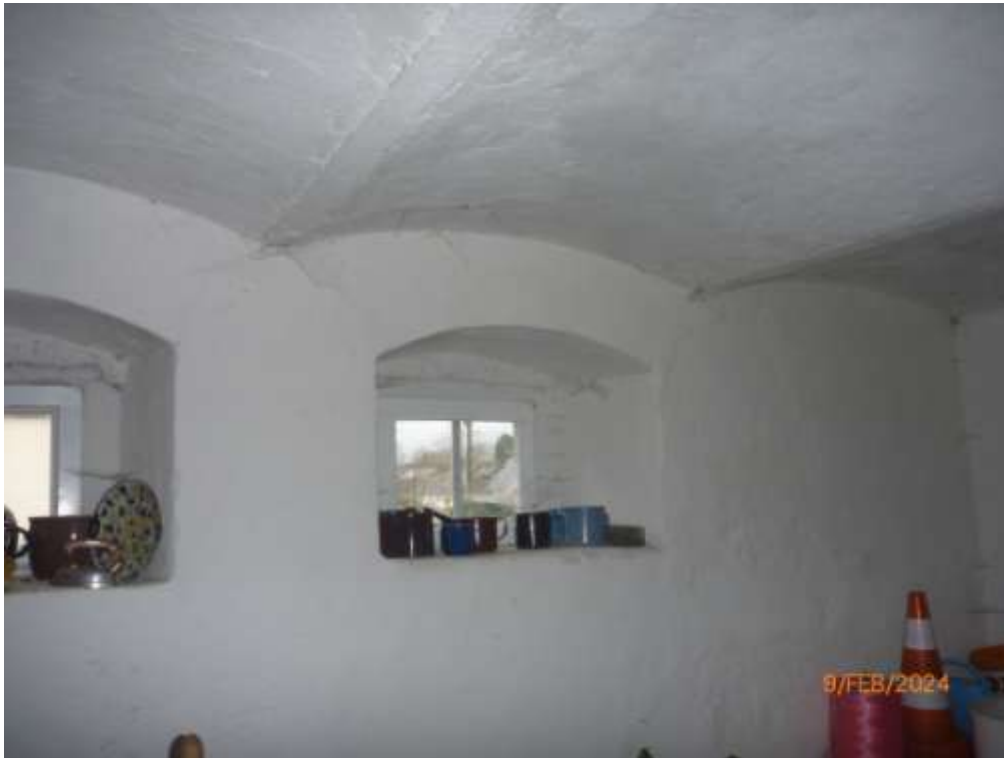
Bild 27: Nebengebäude-III; an der südwestlichen Giebelseite ist die Decke im ehemaligen Stall im Erdgeschoss als Ziegelkappendecke zwischen Stahlträgern ausgeführt
