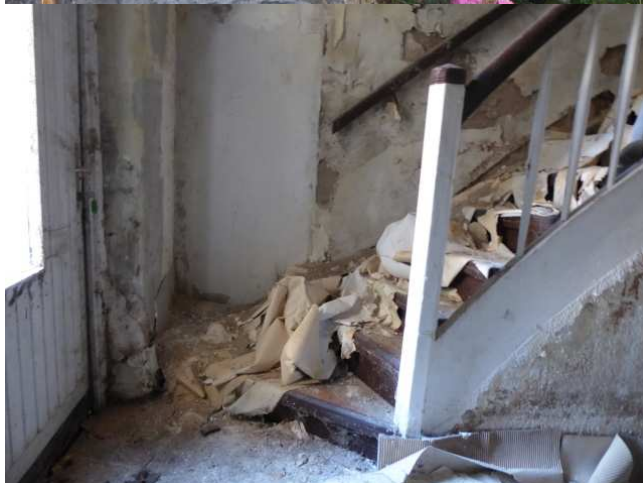
Treppenhausanbau mit schadhafter Geschoßtreppe Foto 12
