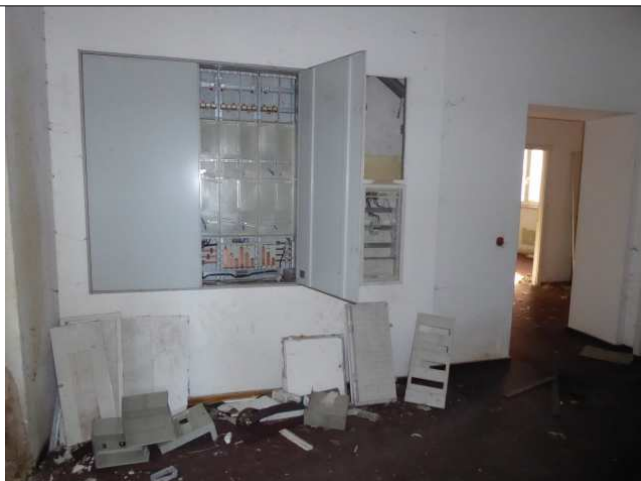
Flurstück 879/3 Baumängel / Bauschäden
