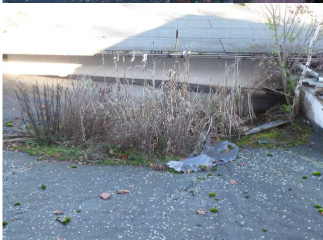
„Feuchtbiotop“ (Wildwuchs) auf dem Dach Foto 6
