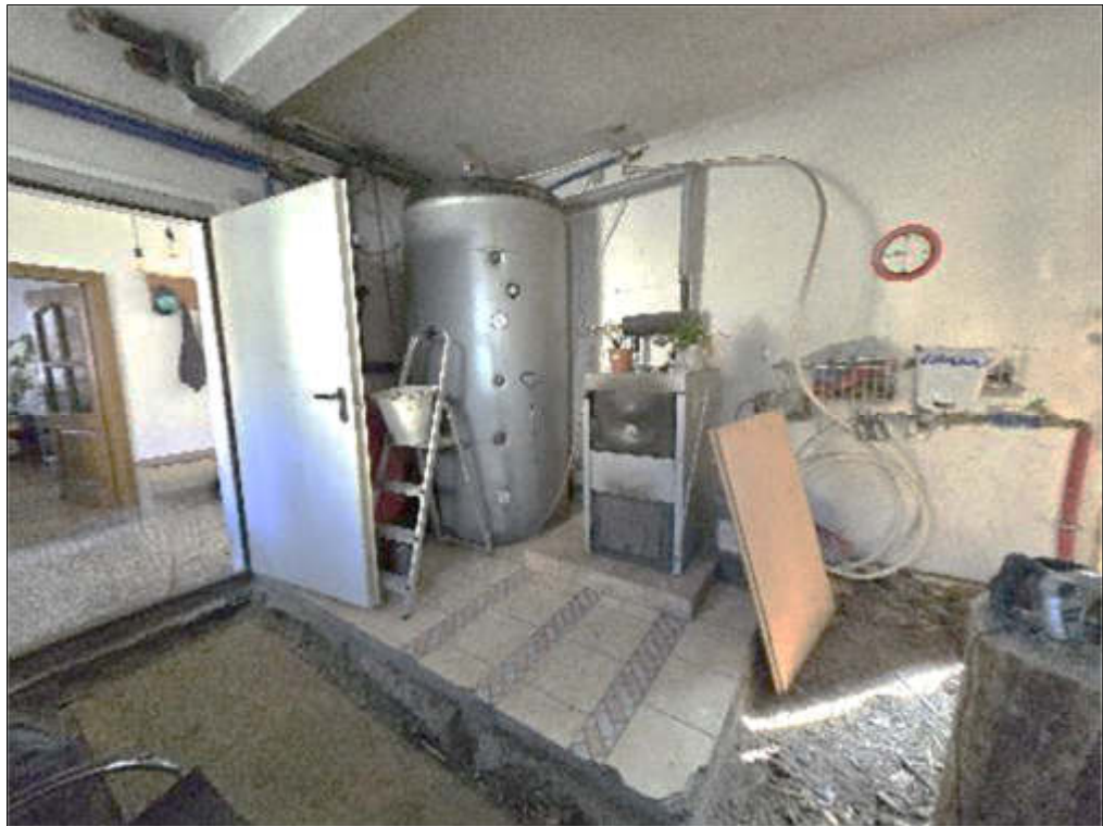
Bild 7 Pos. 01 Wohnhaus, innen, EG Heizung
