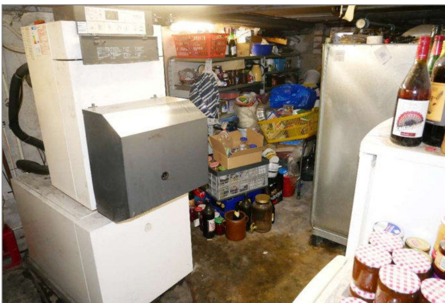
Foto 8 - Wohnhaus - Kellerraum / Heizraum KG
