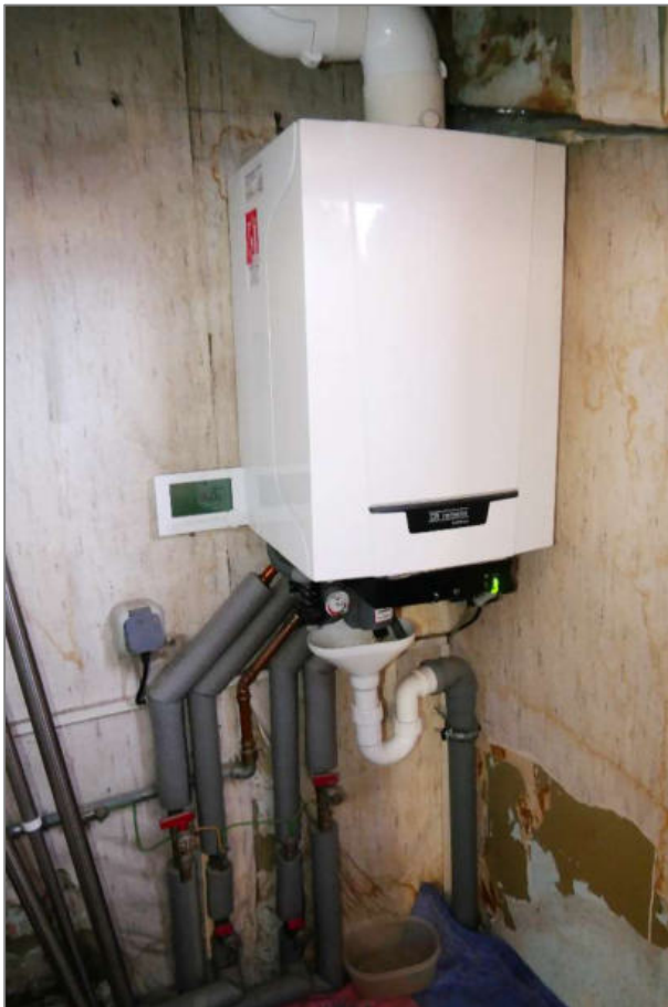
Foto 14 - Wohnhaus - Heiztherme OG
