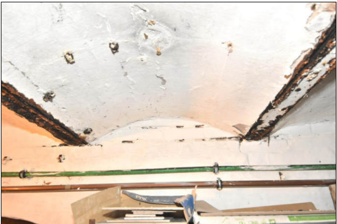
Detailaufnahme der zerstörten Deckenstahlträger
