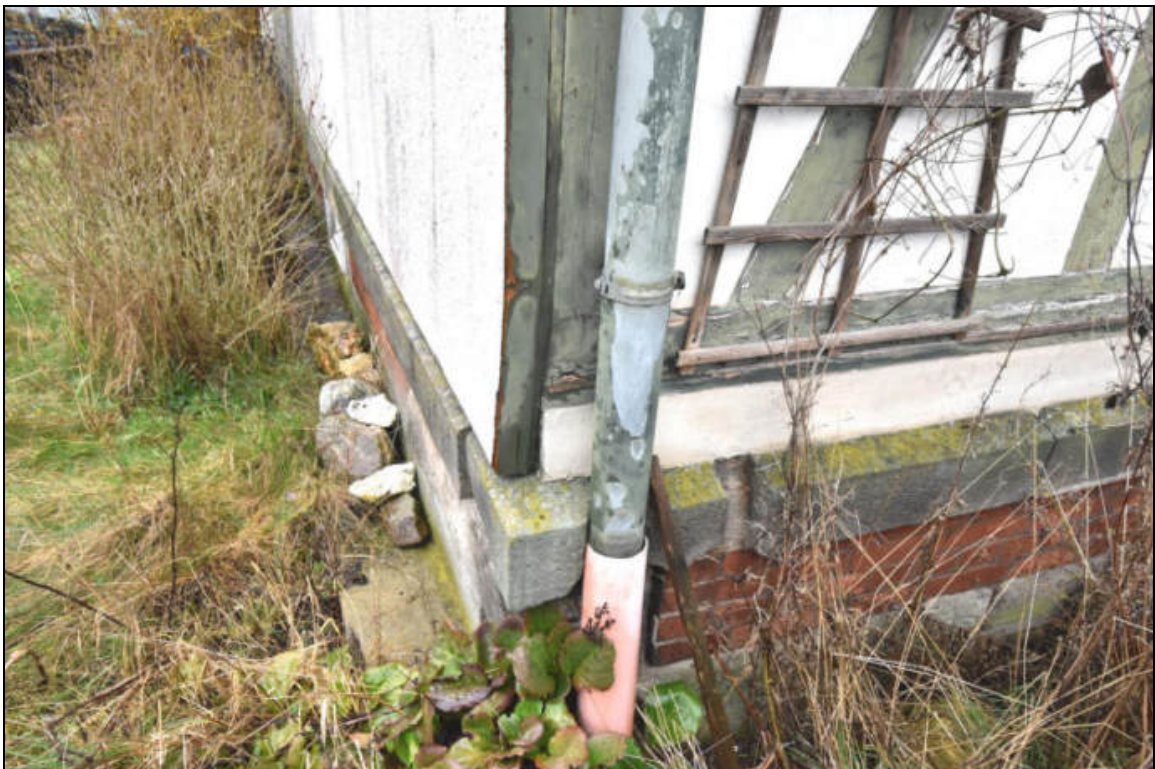
Gebäudesüdecke, Fachwerkschäden im Eckständer- und Schwellbereich durch Feuchtigkeitseinwirkung
