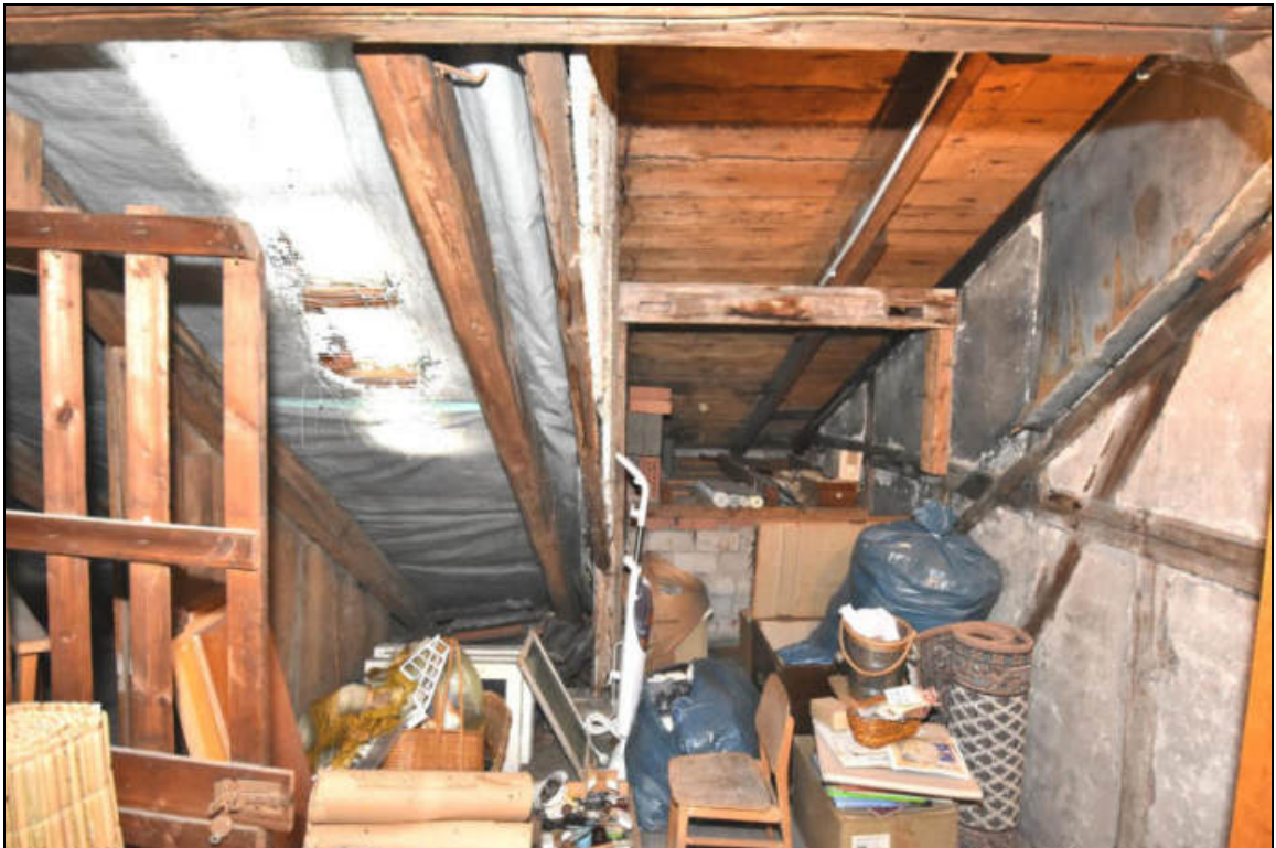
Dachboden mit schadhafter Unterspannbahn durch Lichteinwirkung (Zerfall)
