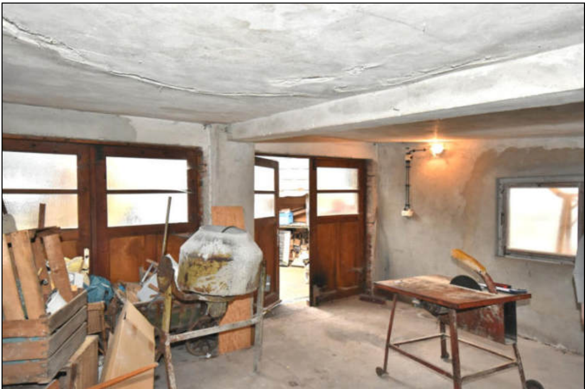
Innenansicht mit Wand- und Deckenputzschäden
