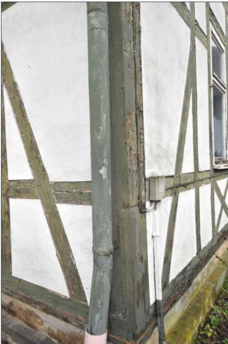
Zweifamilienhaus, Gebäudeostecke, Fachwerkschäden im Eckständer- und Schwellbereich durch Feuchtigkeitseinwirkung, nicht fachgerecht erfolgter Ersatz von substanz- geschädigtem Bereich
