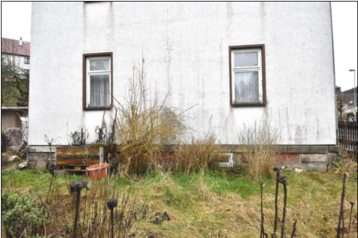
Zweifamilienhaus, südwestliche Giebelseite, sanierungsbedürftige Wärmedämmfassade
