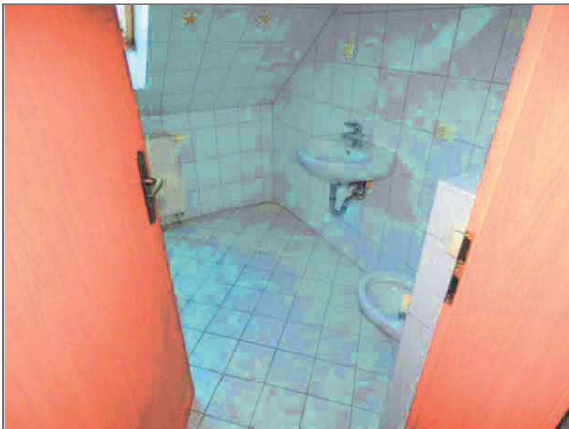
Bild 11: Bad, Fliesen im Eckbereich stark gerissen
