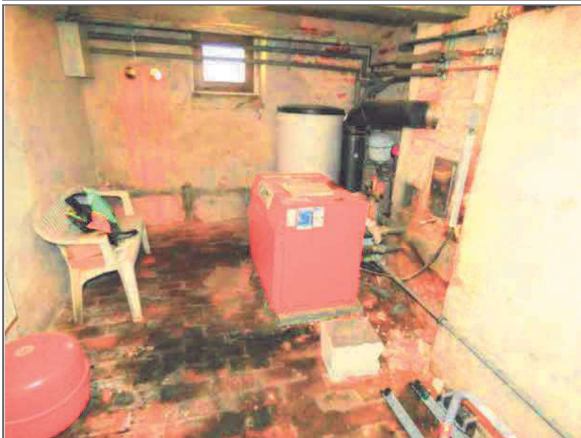
Bild 3: Keller des Wohnhauses, gemeinschaftliche Heizungsanlage
