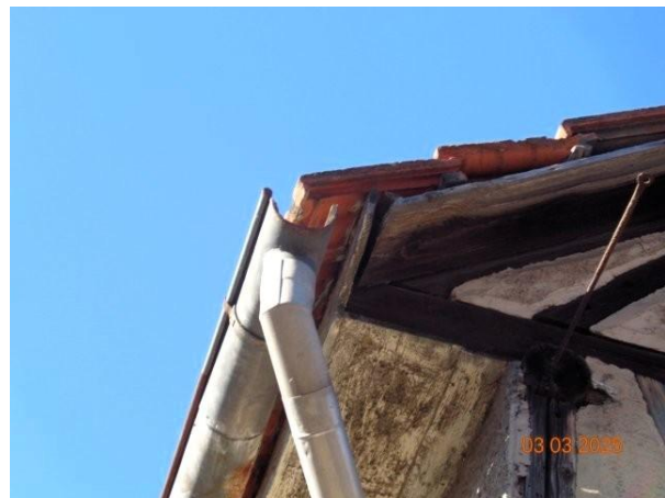
Bild 12: Dachentwässerung nicht funktionstüchtig
