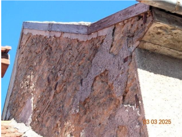
Bild 13: Fassadenputz am Westgiebel fast vollständig fehlend
