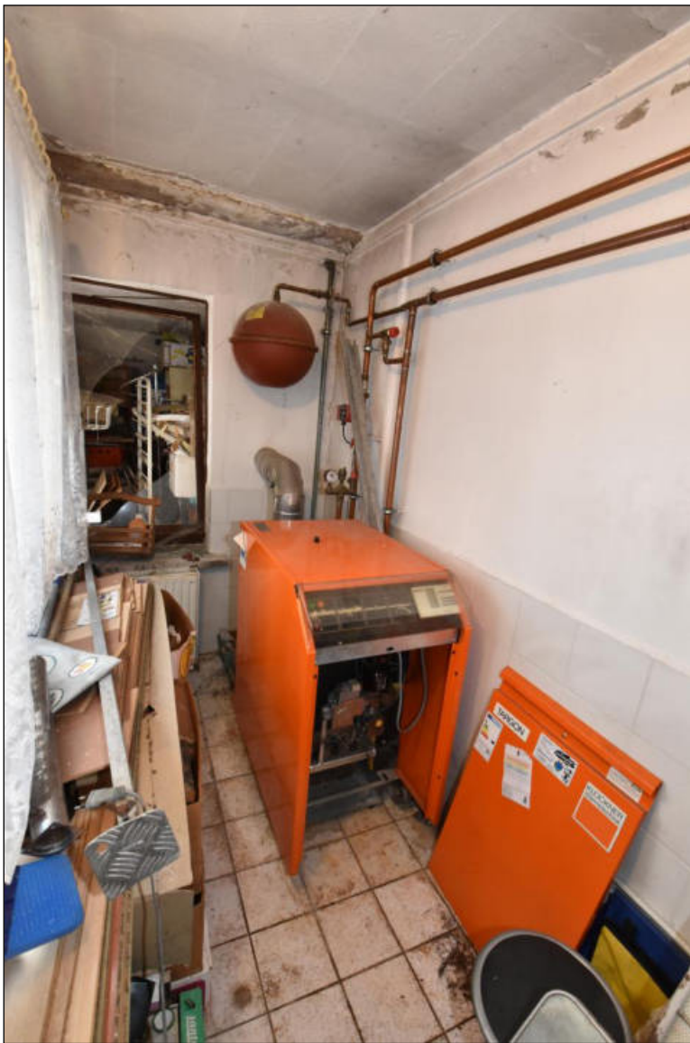
Heizungsraum mit Fenster zum Lager
