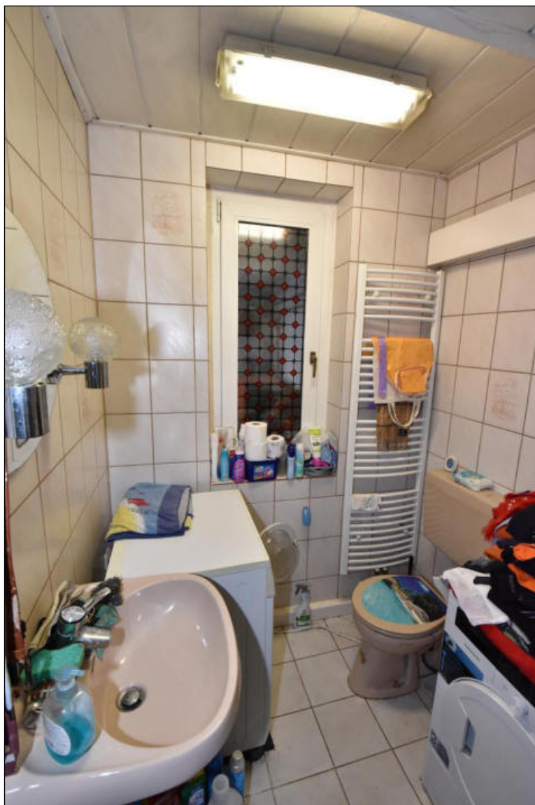
Duschbad / WC mit Fenster zum Heizungsraum
