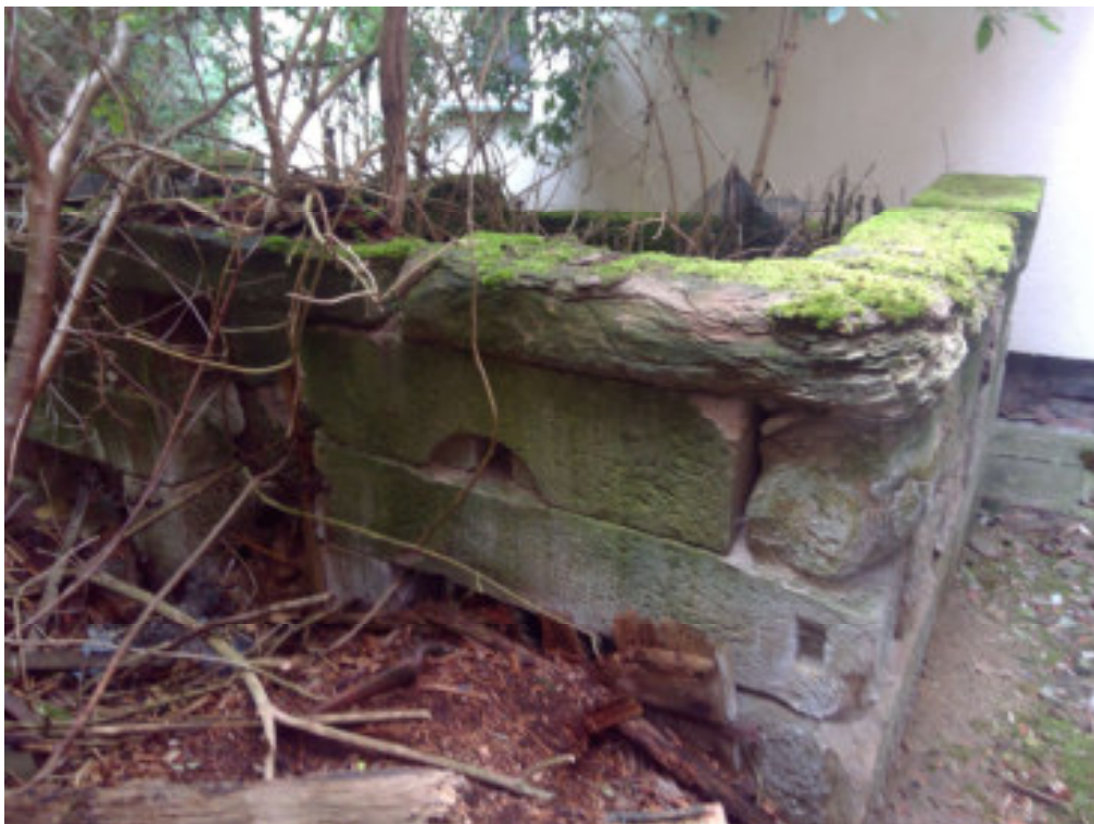
Reste des eingestürzten bzw. abgerissenen Stalls
