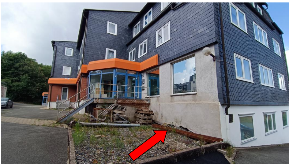
Ostansicht Hotel mit Sockelschäden
