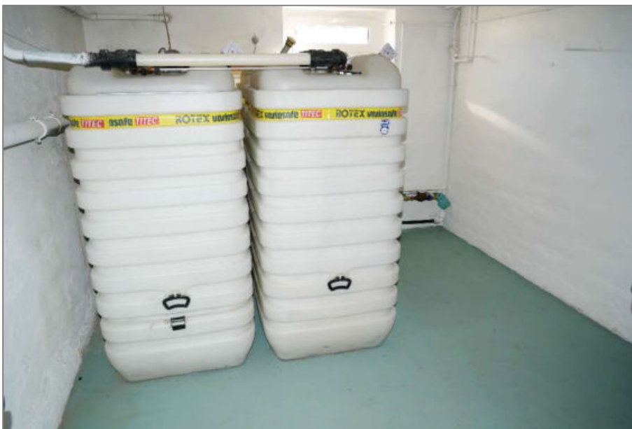
Foto 7 - Wohnhaus - Öltanks KG
