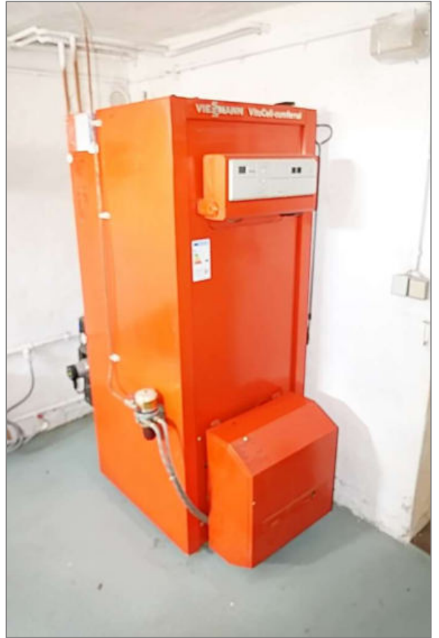
Foto 6 - Wohnhaus - Heizung KG
