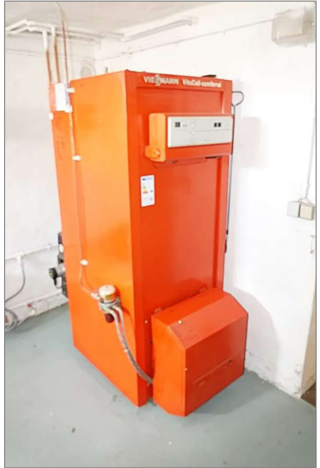
Foto 6 - Wohnhaus - Heizung KG
