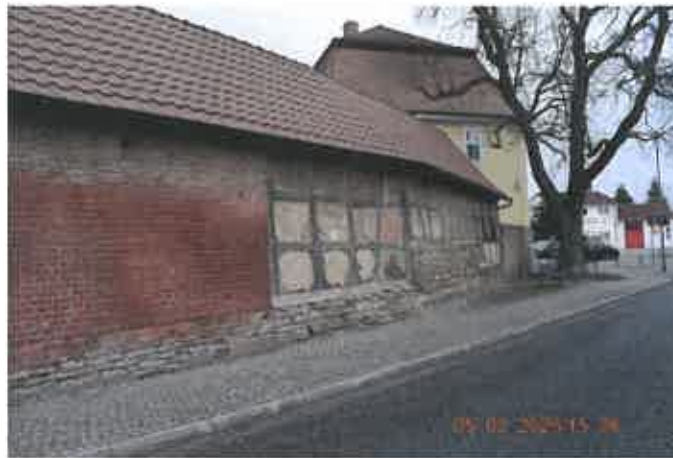
schadhafte Fassade Nebengebäude
