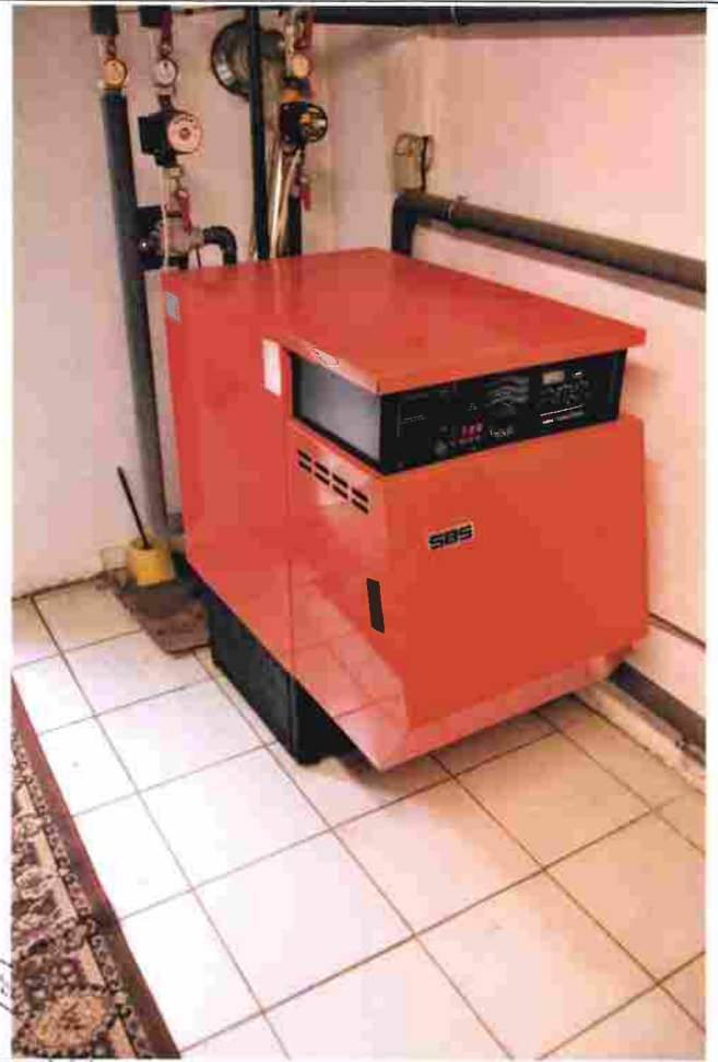
Wohnhaus Erdgeschoss Heizungsraum
