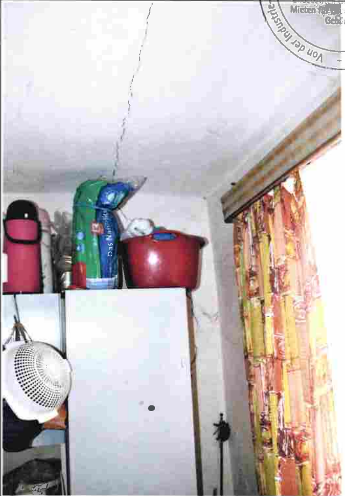
Wohnhaus Erdgeschoss Risse Abstellraum
