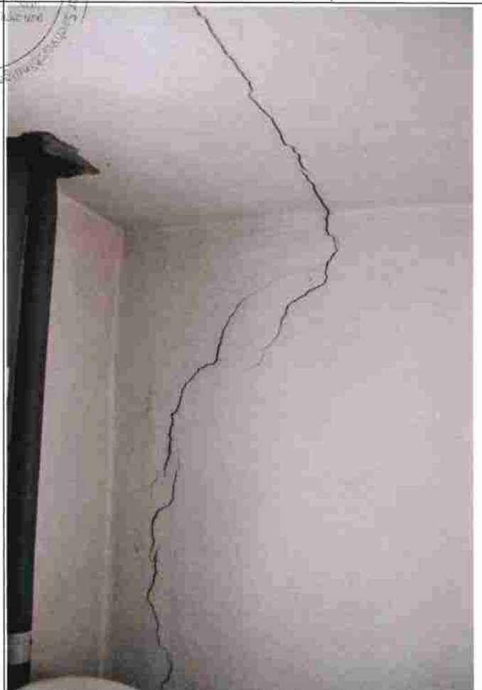
Wohnhaus Erdgeschoss Risse Heizungsraum
