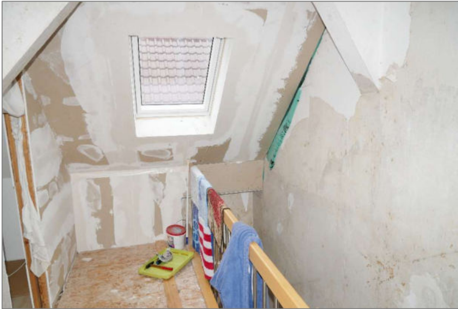
Foto 12 - Wohnhaus - Flur DG
