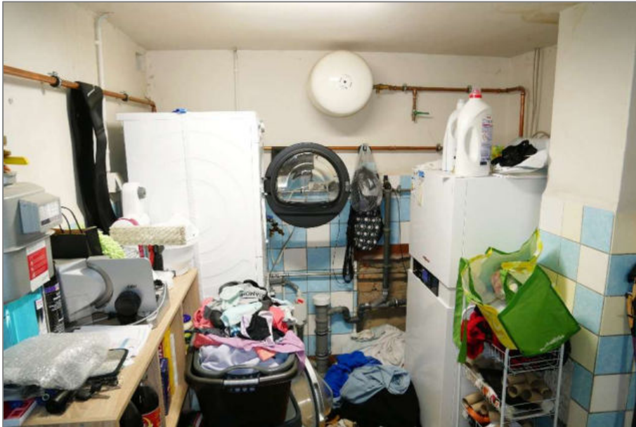
Foto 11 - Wohnhaus - Waschküche / Heizraum EG
