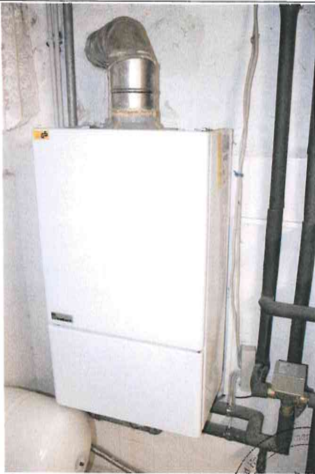
Flurstück 73 Wohnhaus Erdgeschoss Heiztherme
