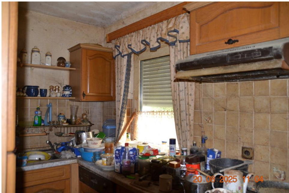
Vermüllter Zustand der Küche im Erdgeschoss
