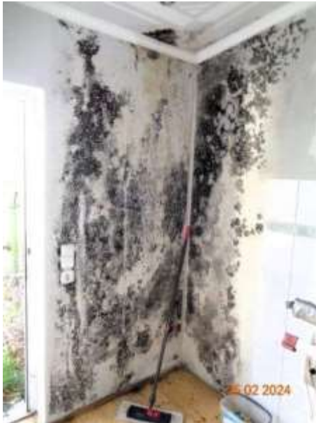
Bild 7: Schwarzsimmelbildung wie vor; starke Durchfeuchtung Umfassungswand
