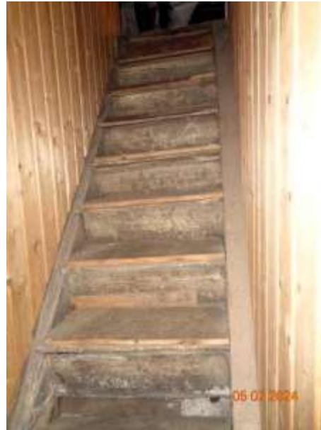
Bild 14: Holzstiegenzugang vom Erdgeschoss zum nicht ausgebauten Dachgeschoss; sehr beengt; Treppe schadhaft
