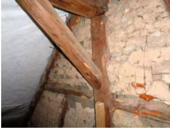
Bild 17: partieller Schädlingsbefall an Holzpfettenkonstruktion des Dachgeschosses; in anderen, nicht sichtbaren Bereichen weiterer Befall nicht ausschließbar
