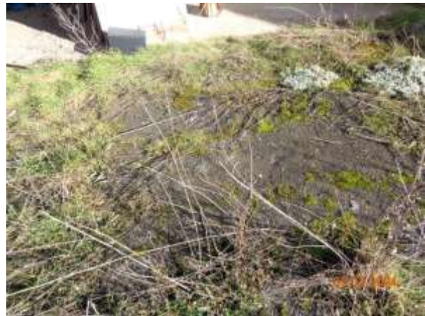
Bild 20: Ort betonfläche im Hofbereich; allgemein verbraucht; teilweise schadhaft
