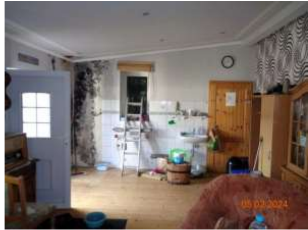
Bild 6: Innenansicht separaten Wohnraums im hofseitigen Wohnhausanbau; Schwarzsimmelbildung linksseitig (Anschlussbereich zum Wohnhaus); mittig Badfenster vom Wohnhaus; rechts Kellertür (keine Zugangsmöglichkeit)
