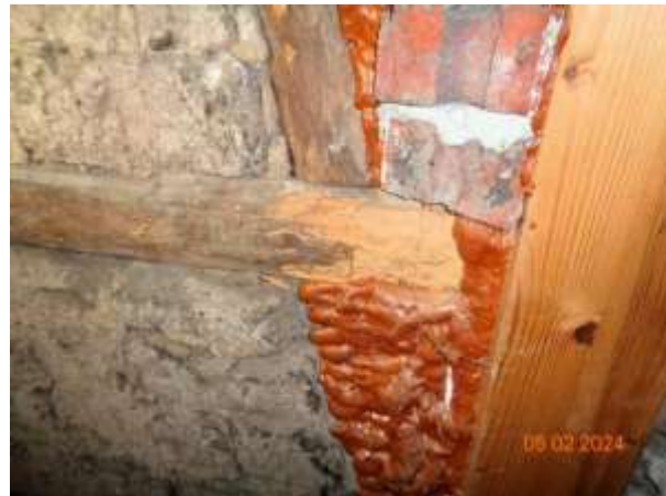
Bild 16: partieller Schädlingsbefall am Fachwerkgiebel des Wohnhauses südseitig; in anderen, nicht sichtbaren Bereichen weiterer Befall nicht ausschließbar
