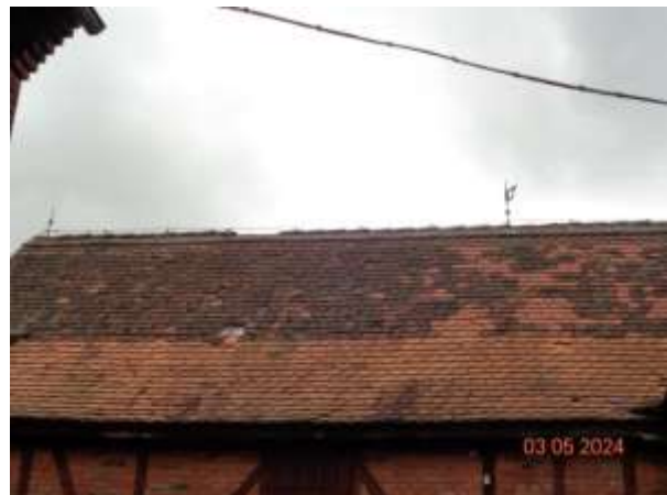
Bild 36: Firstziegel auf Scheunendach teilweise fehlend; keine Dachentwässerung vorhanden
