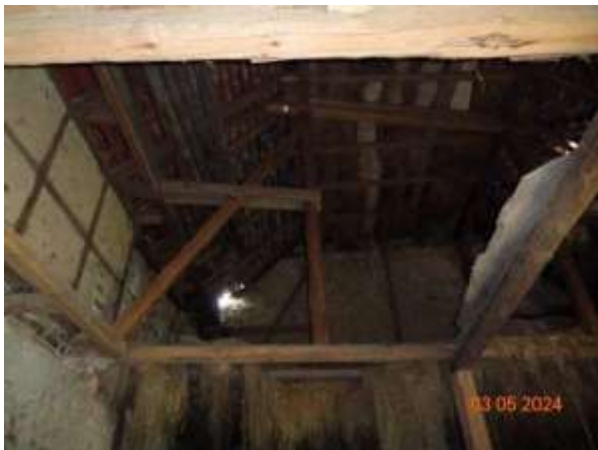
Bild 35: Dachkonstruktion des Scheunengebäudes; zum Teil Fehlstellen in der Dacheindeckung
