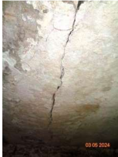
Bild 26: Rissbildung Deckenbereich ehemaliges Stallgebäude
