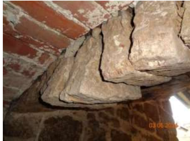
Bild 34: Steine im Natursteingewölbe des Scheunenkellers zum Teil lose
