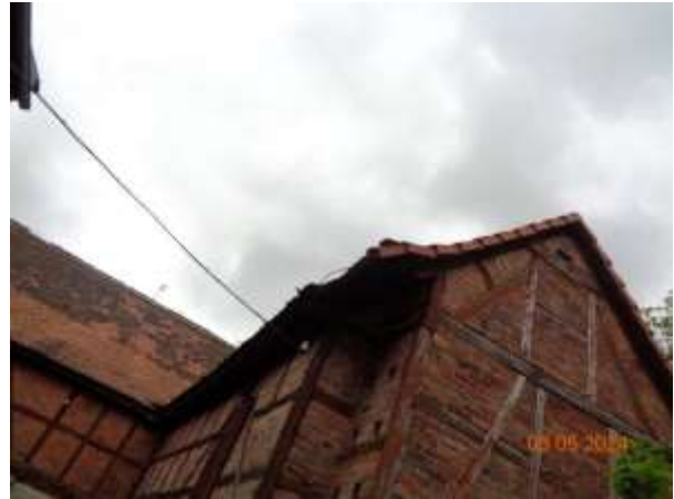
Bild 30: Dachziegel am Lagergebäude teilweise lose; keine Dachentwässerung vorhanden
