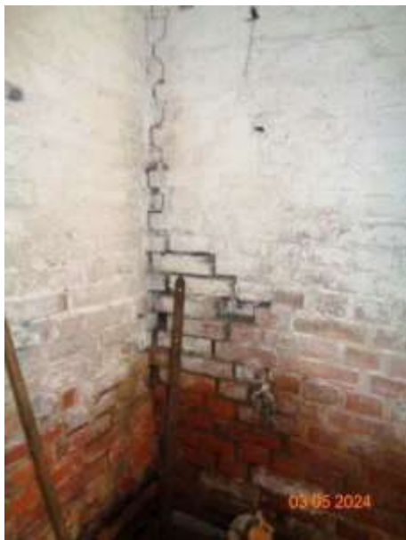
Bild 21: Störungen/Setzungen im Mauerwerk ehemalige Waschküche
