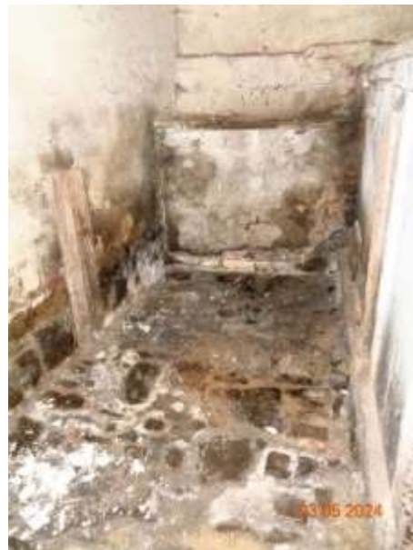
Bild 28: aufsteigende Feuchtigkeit in massivem Umfang an Umfassungswänden des ehemaligen Stallgebäudes
