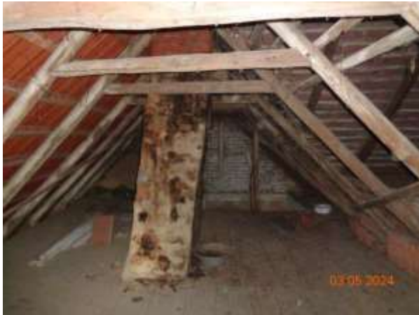
Bild 17: nicht ausgebautes Dachgeschoss im östlichen Gebäudeteil des Wohnhauses; Schornstein versottet
