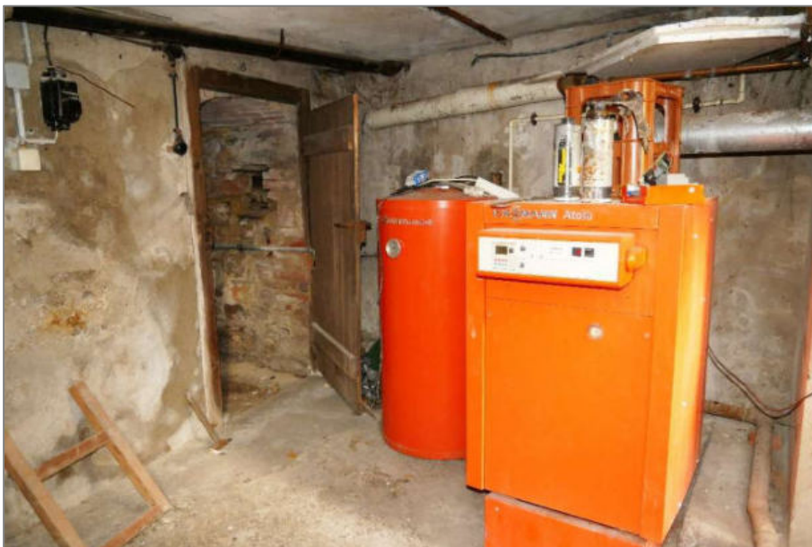
Foto 4 - Wohnhaus - Heizraum KG im rückseitigen Anbau
