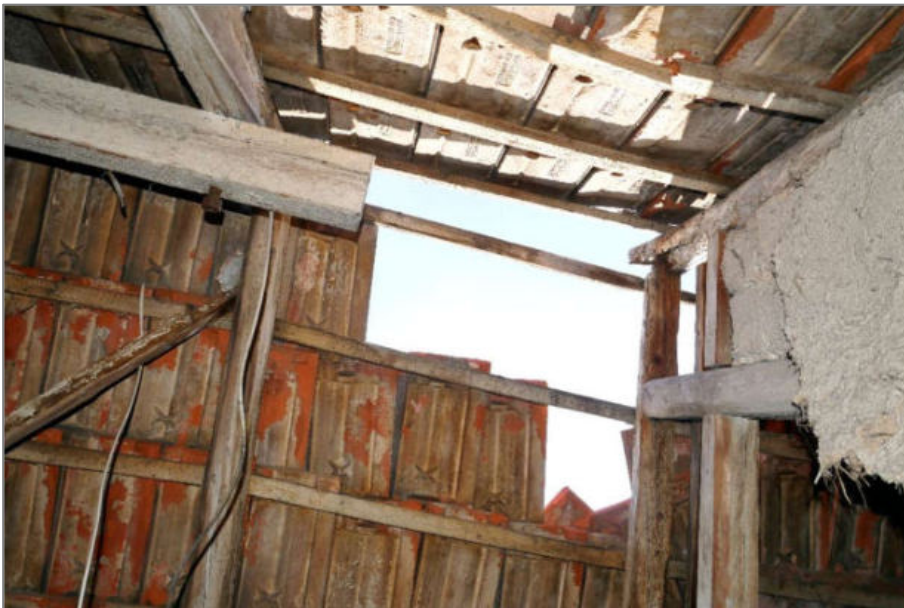
Foto 19 - Wohnhaus - schadhafte Dachdeckung
