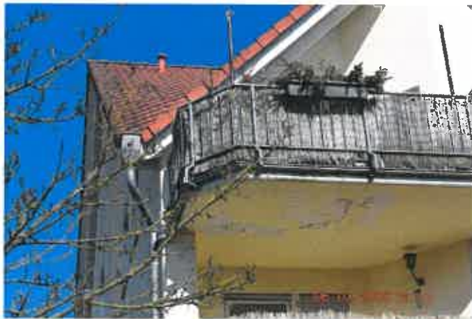
Farbabplatzungen Betonplatte über der ETW 5
