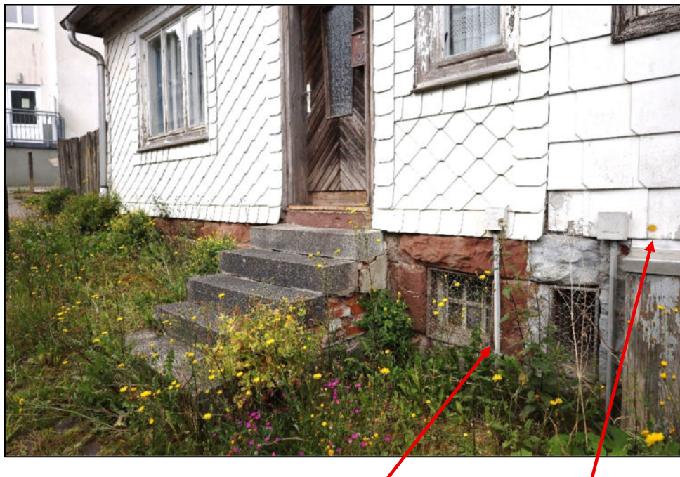
Hauseingang links mit Telefon u. Gasanschluss
