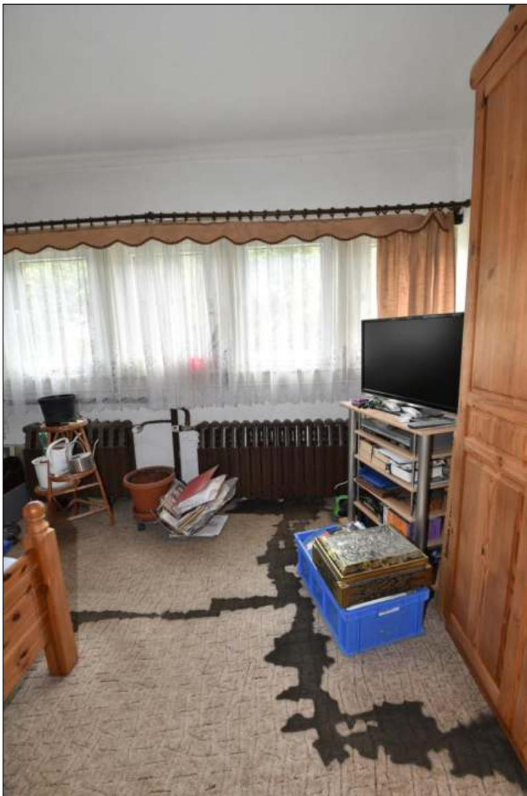
Dachgeschoss, Zimmer Südwest (Dachgaube) mit zerstörtem Heizkörper
