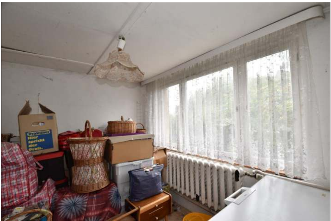
Zimmer Nordecke mit zerstörtem Heizkörper
