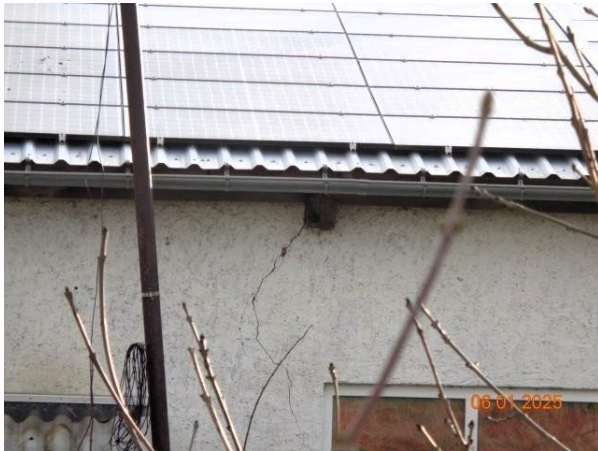
Bild 5: Gebäude 1 – partiell Rissbildung Umfassungswände gebäudenordseitig
